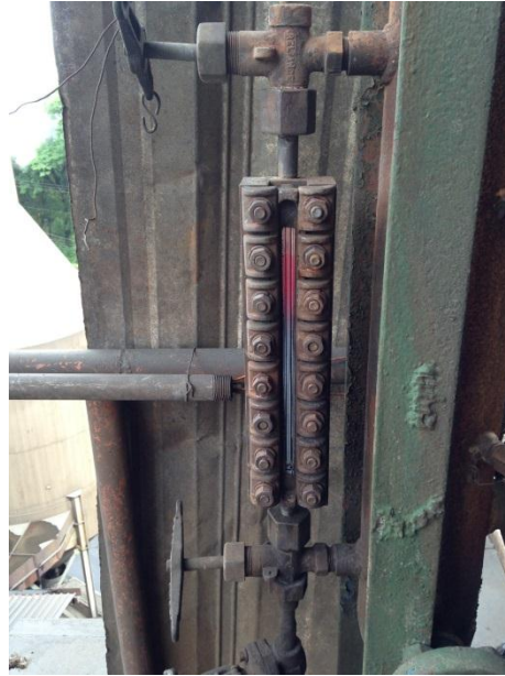
Medidor de nivel de agua
