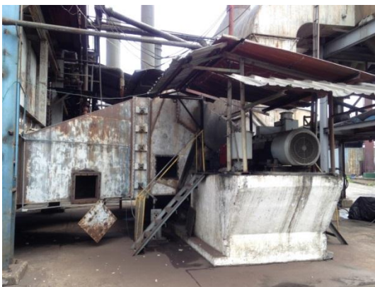
Ventilador de tiro inducido
