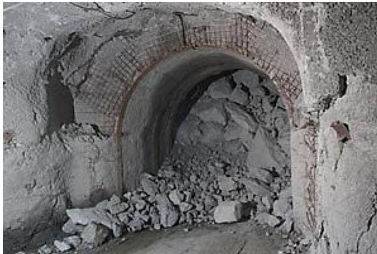
Figura 19. Derrumbe de material en túneles
