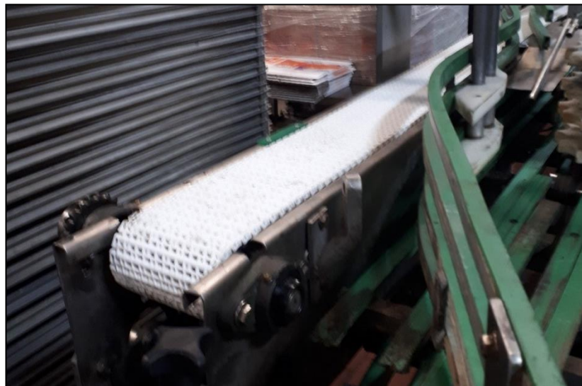
Figura 38. Reemplazo del Transportador
