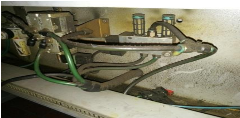
Figura 16. Daño en electroválvulas
