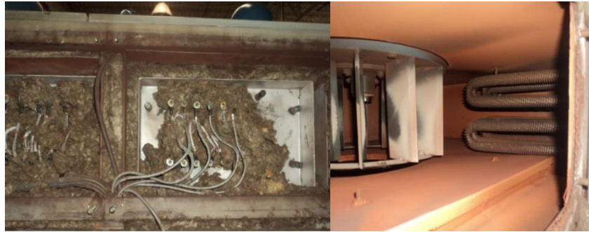
Figura 17. Deterioro del horno de termocontracción
