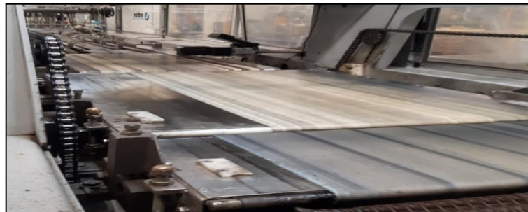
Figura 31. Estado inicial de los transportadores
