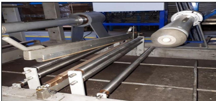
Figura 34. Nuevo sistema de alimentación de polietileno
