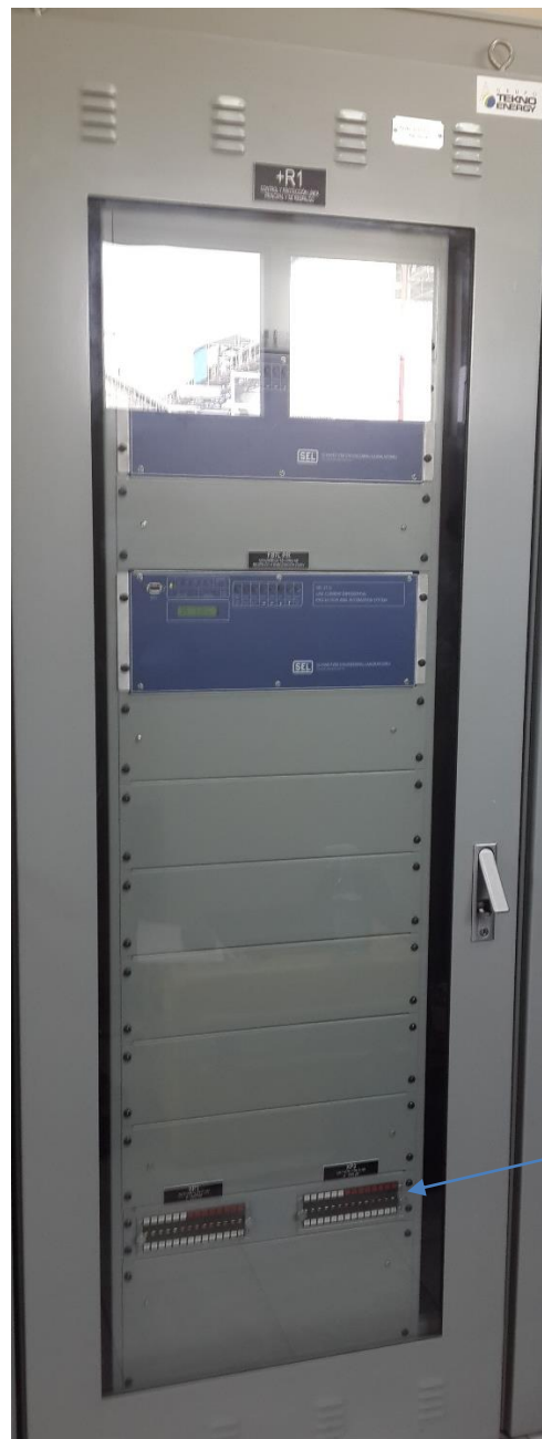
Figura 31. Bloque de pruebas en gabinete para relevador SEL311L
