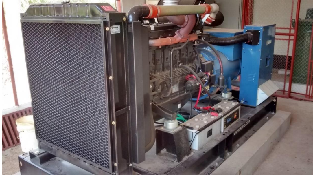
Figura 42. Generador eléctrico de 300 kw, pe 36
