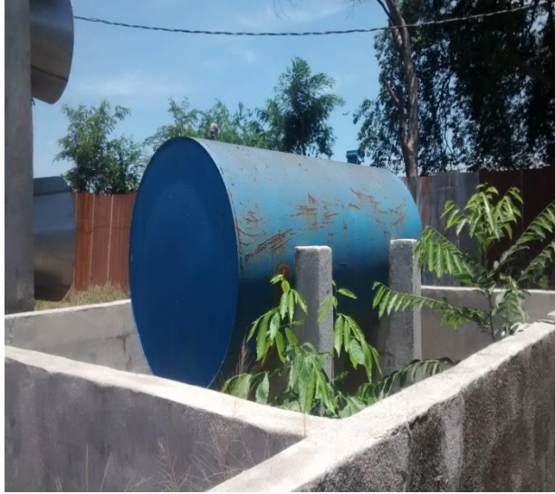
Figura 15. Tanque de diesel 2 000 galones capacidad, generador pe 11
