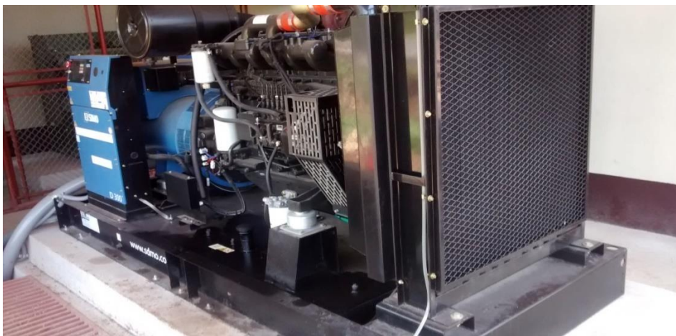
Figura 41. Generador eléctrico de 300 kw, pe 35
