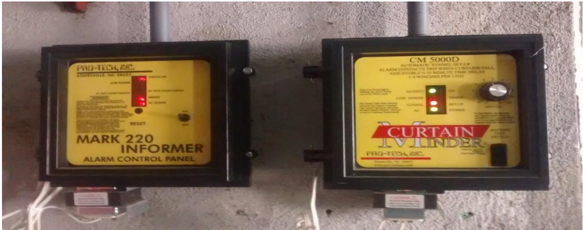
Figura 77. Paneles de control de alarmas internas de una galera túnel
