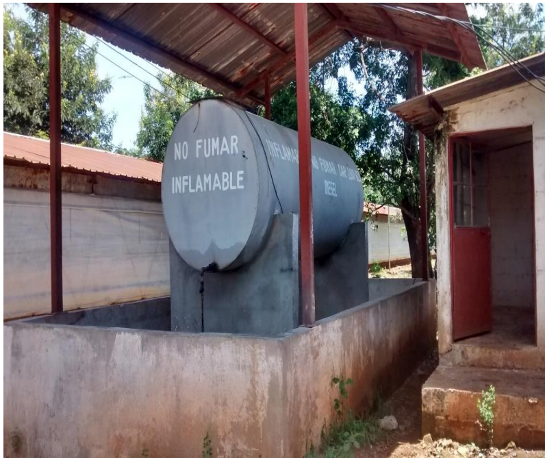
Figura 17. Tanque de diesel 2 000 galones capacidad, generador pe 23
