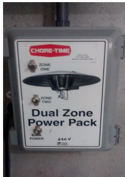
Figura 73. Equipo de encendido de criadoras dos zonas Chore Time
