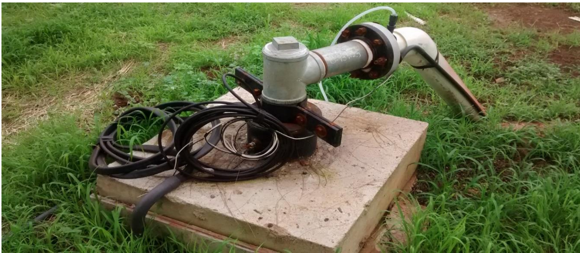
Figura 45. Brocal de pozo mecánico sumergible
