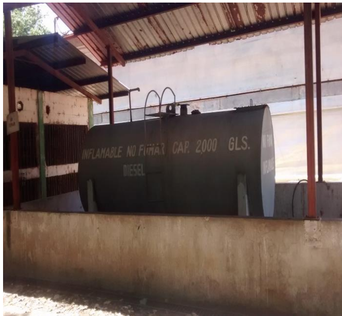
Figura 16. Tanque de diesel 500 galones capacidad, generador pe 29
