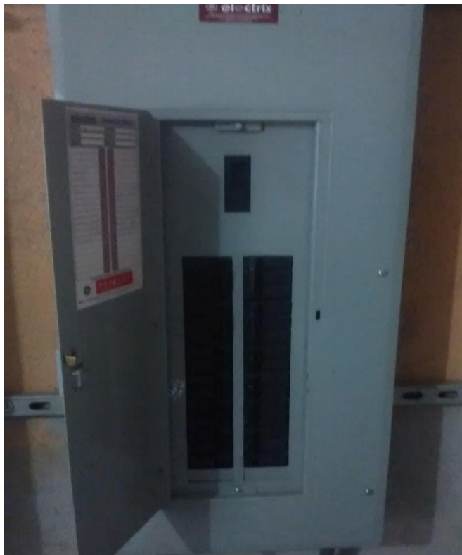
Figura 74. Tablero de suministro eléctrico
