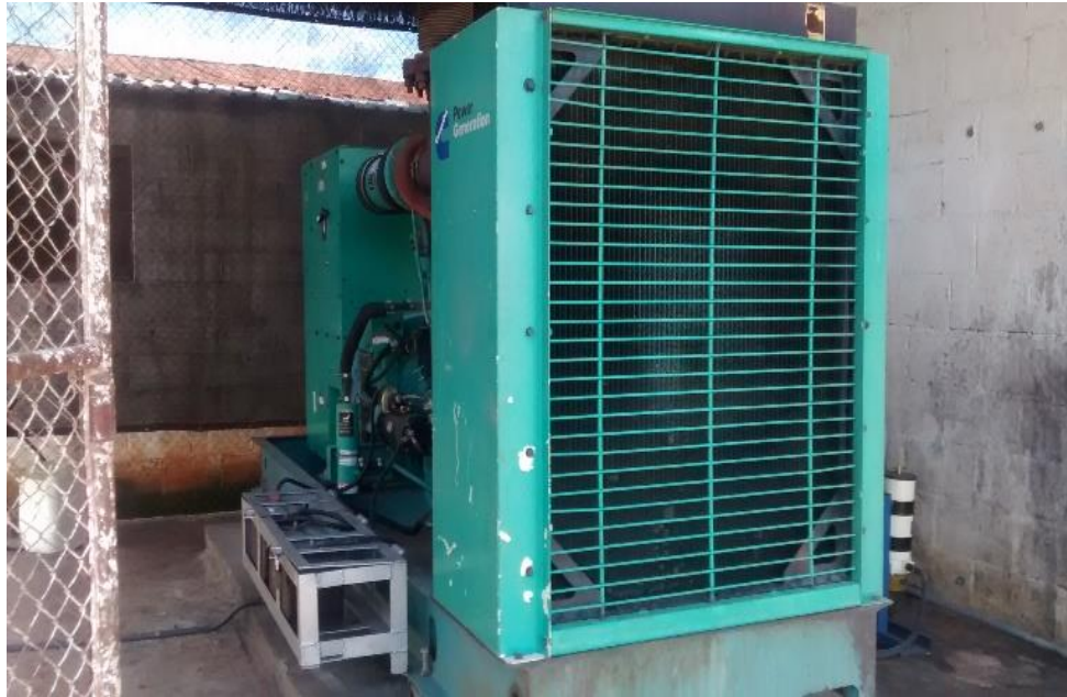
Figura 14. Generador pe23, capacidad 135 kw
