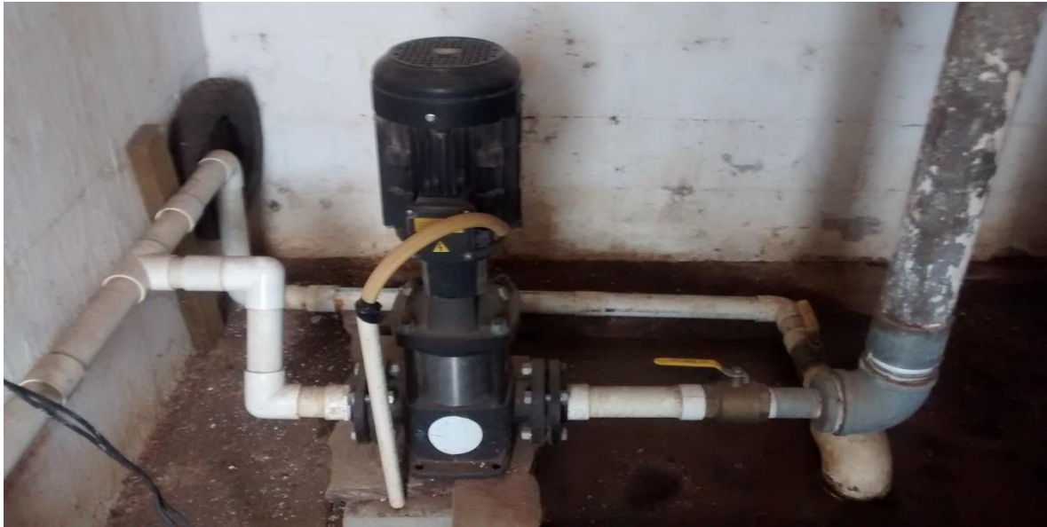
Figura 21. Motor eléctrico y bomba hidroneumática de presión
