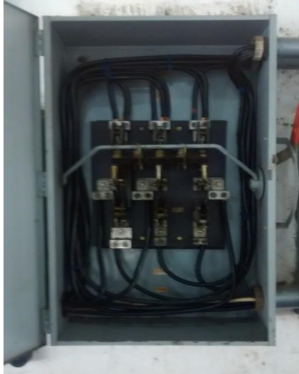
Figura 18. Panel de transferencia manual de 600 AMP
