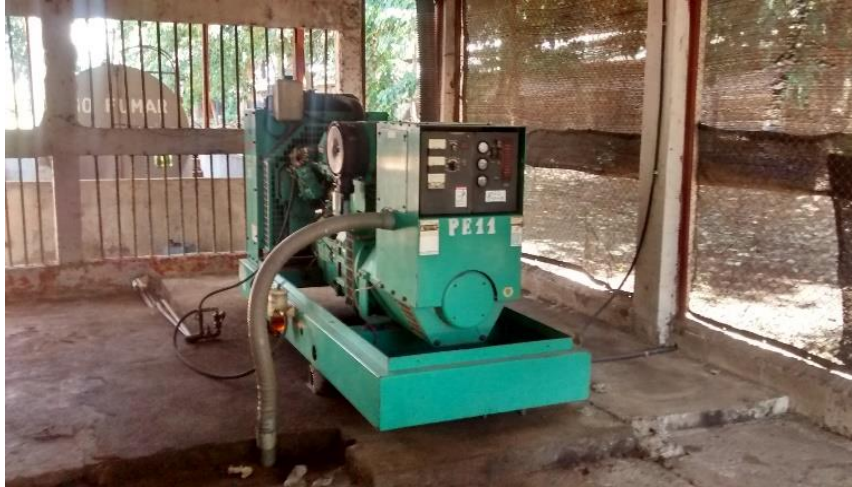
Figura 12. Generador pe11, capacidad 150 kw
