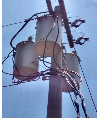
Figura 10. Posteado eléctrico de alta con transformadores de baja de 3 * 50 KVA
