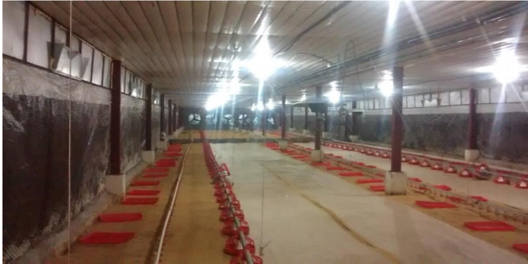
Figura 61. Sistema de iluminación de una galera tipo túnel automatizada
