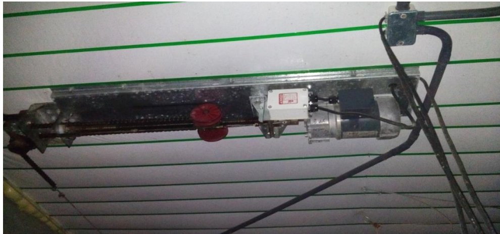
Figura 83. Motorreductor automatizado para activar cortinas laterales
