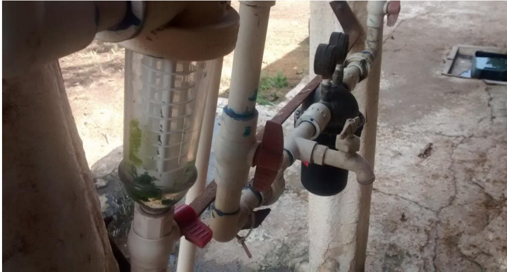
Figura 36. Sistema de dosificación de químicos
