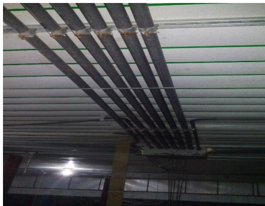
Figura 63. Cableado interno de una galera túnel
