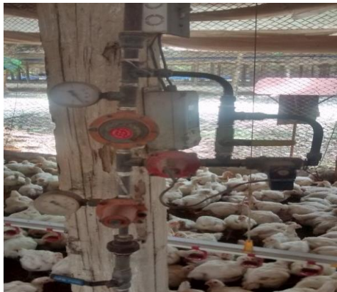
Figura 28. Sistema de regulación de gas dentro de la galera
