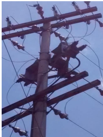
Figura 2. Poste con Pt's y Ct's
