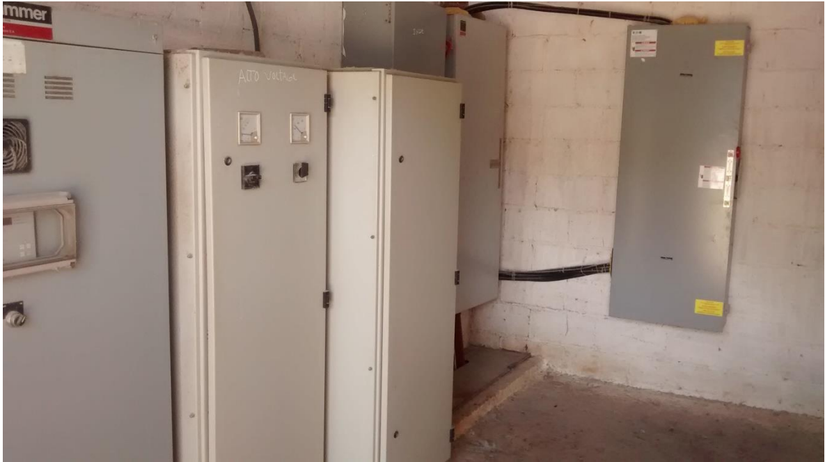
Figura 43. Caseta de panel de transferencia automática
