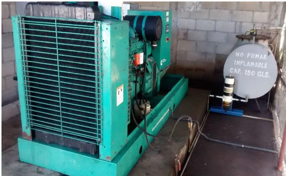
Figura 13. Generador PE29, capacidad 275 kw
