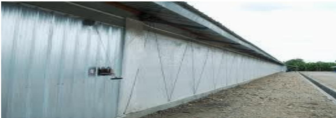
Figura 82. Cortinas laterales de galeras tipo túnel
