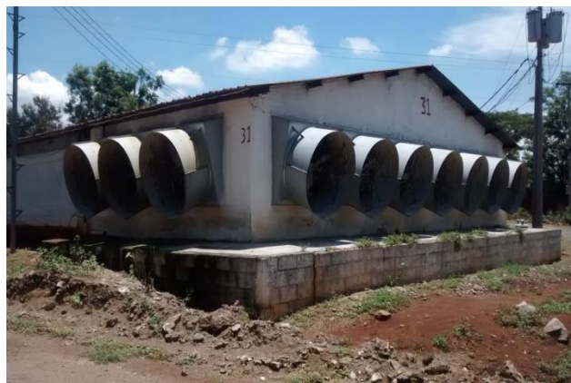
Figura 64. Extractores de una galera tipo túnel
