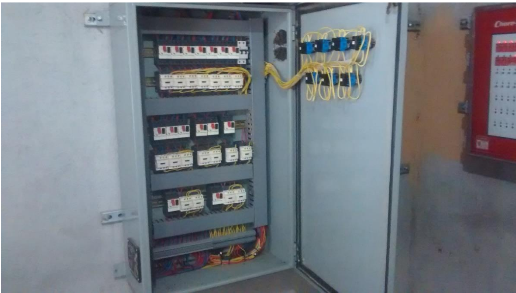
Figura 76. Panel de contactores y térmicos
