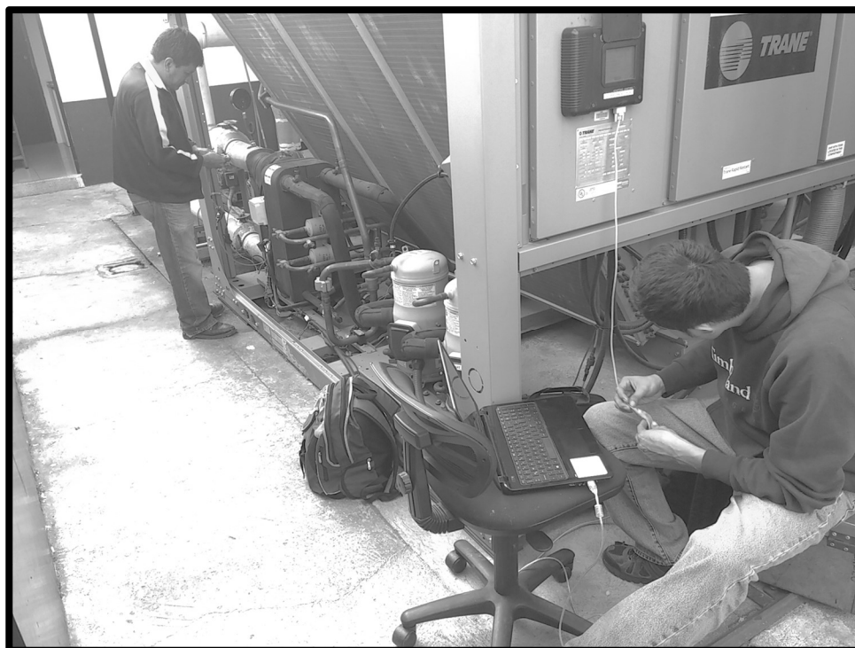
Figura 13. Equipo Chiller instalado en zona 9
