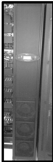
Figura 17. Sistema Inrow instalado
