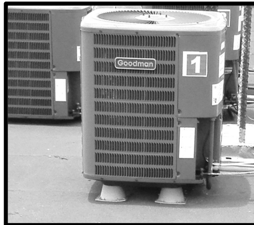
Figura 26. Condensadora con bases anti vibración
