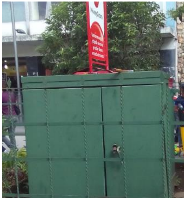
Figura 17. Transformador trifásico tipo pedestal 300 kVA
