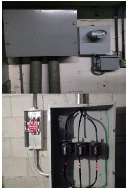
Figura 24. Medición secundaria en cuarto eléctrico
