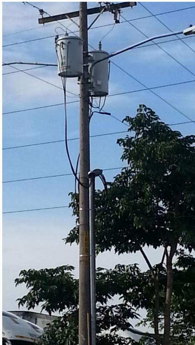
Figura 16. Transformador CSP con bajada secundaria
