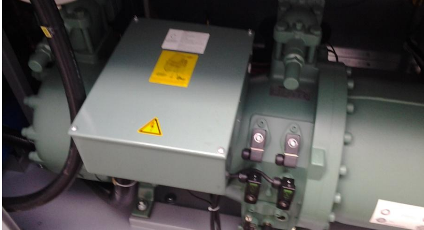
Figura 34. Compresor semi-hermético de refrigeración
