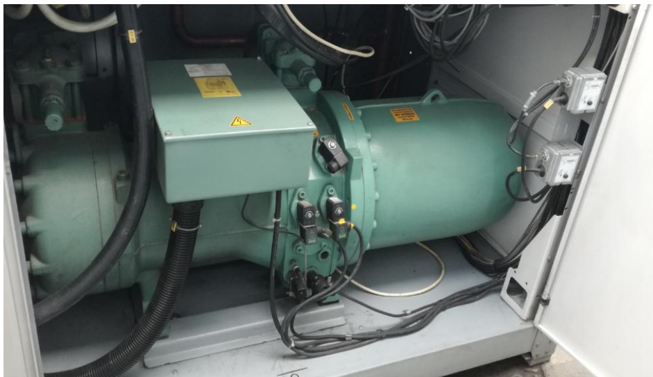
Figura 33. Compresor semi-hermético de refrigeración
