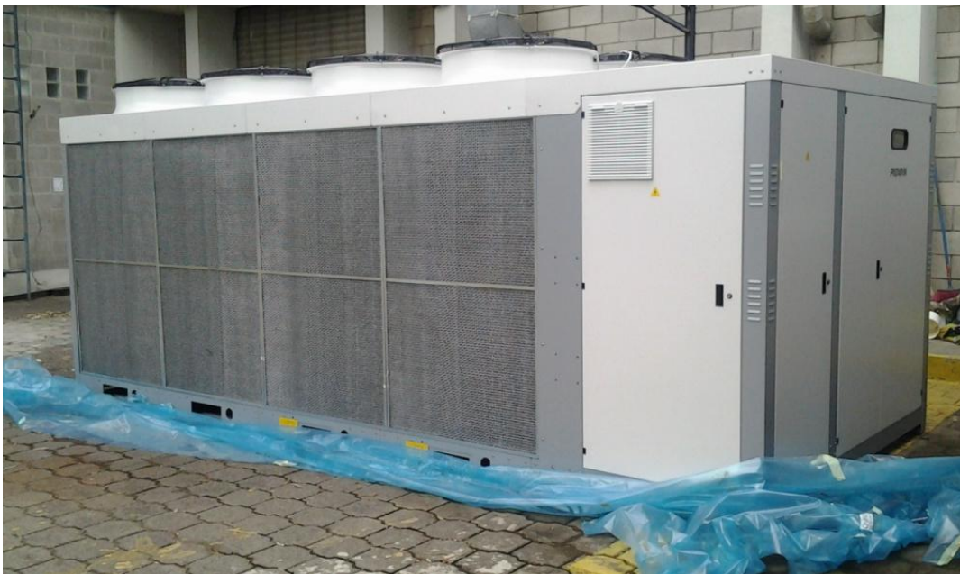
Figura 32. Equipo tipo chiller
