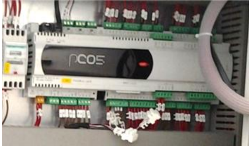
Figura 38. Sistema eléctrico del chiller
