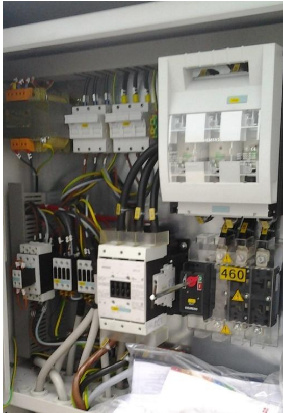
Figura 39. Sistema eléctrico del chiller
