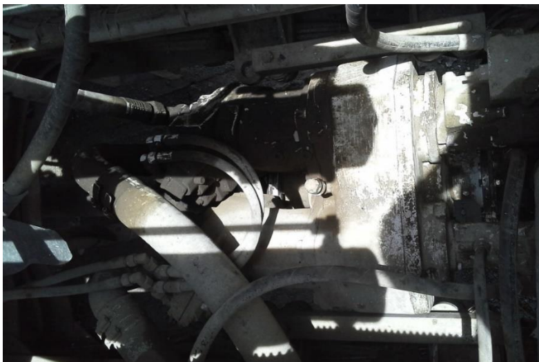
Figura 33. Mangueras de las bombas hidráulicas
