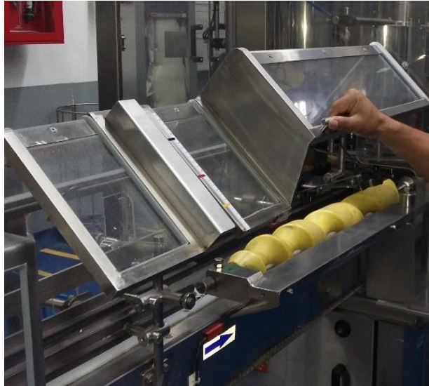
Figura 44. Guarda de acceso con Interlock de seguridad
