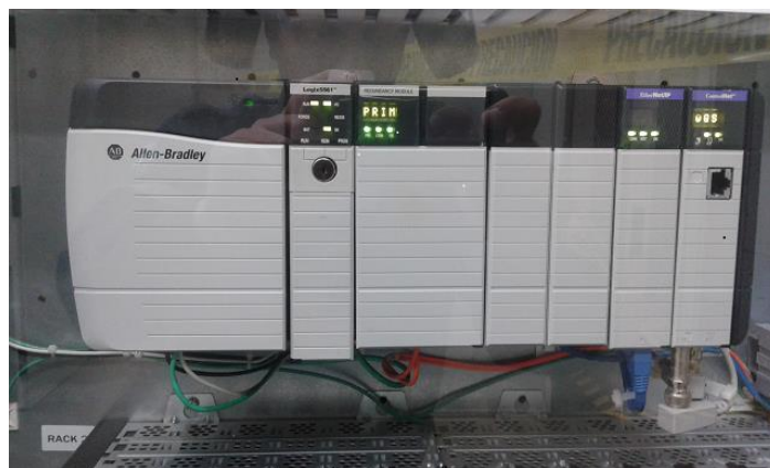
Figura 23. Fotografía del PLC Allen Bradley RSLOGIX 5000
