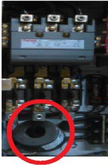
Figura 61. Transformador de corriente instalado en la fase B
