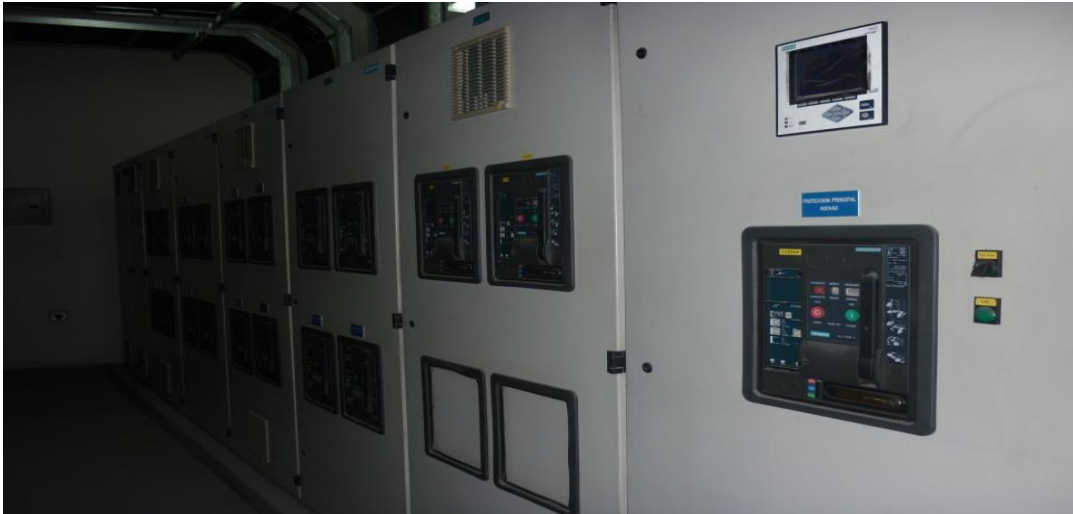
Figura 9. Paneles de distribución
