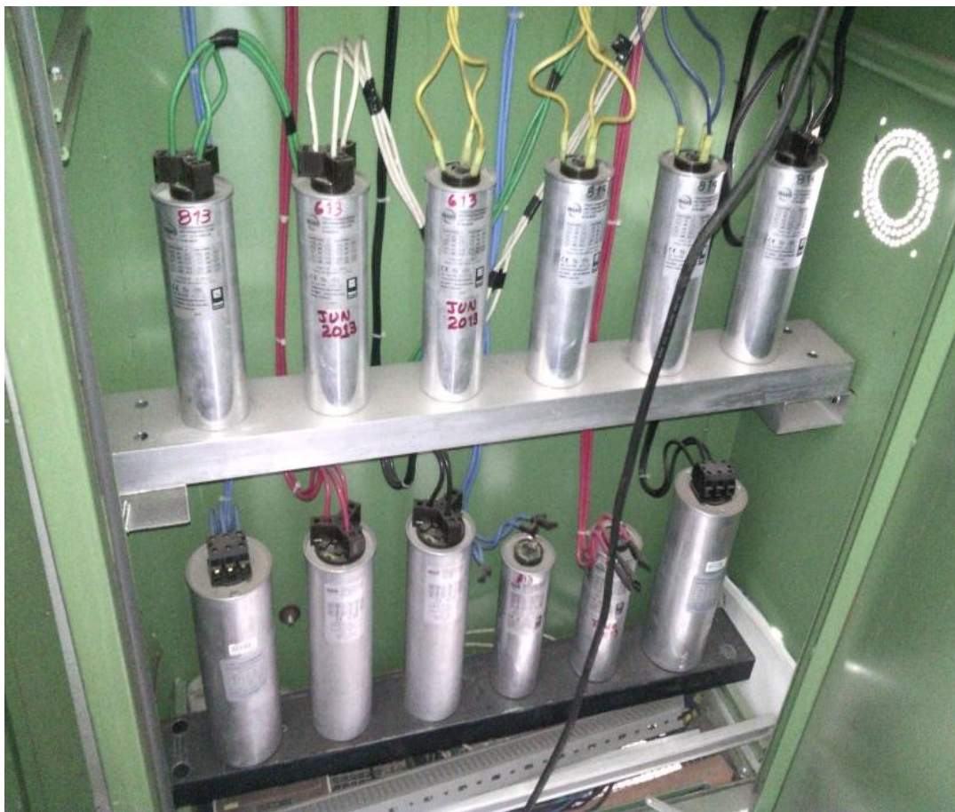
Figura 44. Capacitores de regulación de F.P.
