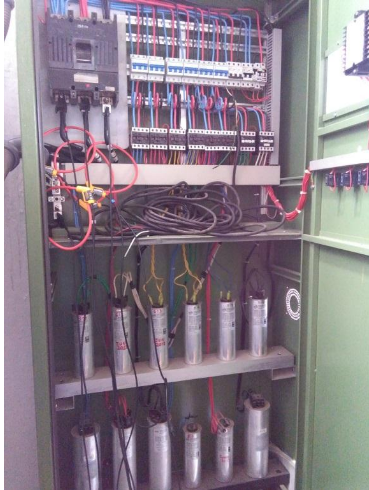
Figura 29. Banco de capacitores
