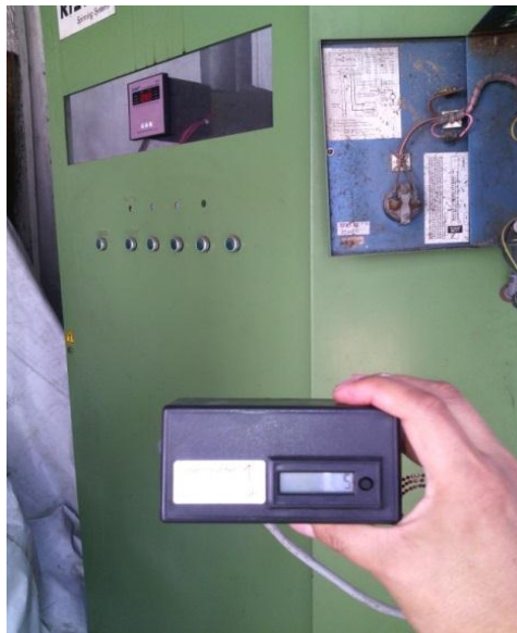
Figura 15. Contador de eventos en un banco de capacitores
