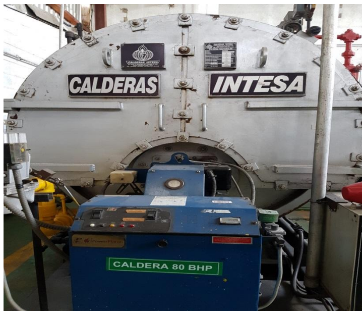
Figura 10. Caldera núm. 1 potencia de 80BHP
