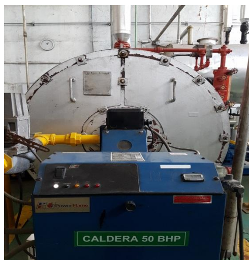
Figura 12. Caldera núm. 2 potencia 50 BHP
