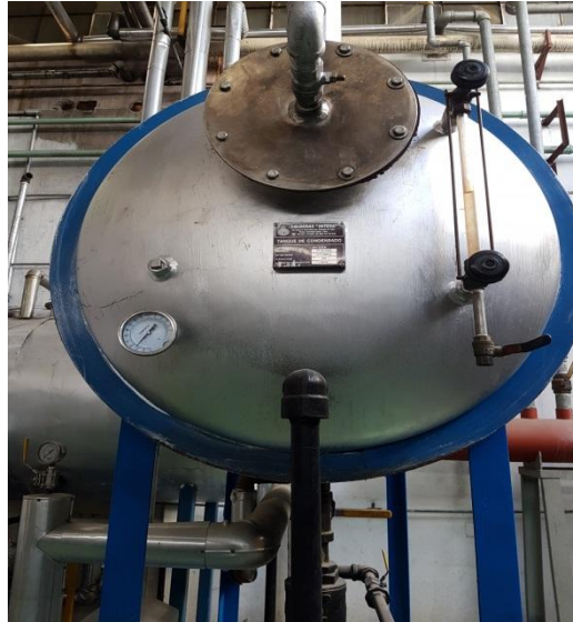
Figura 17. Tanque de recuperación de condensado. Capacidad 200 galones
