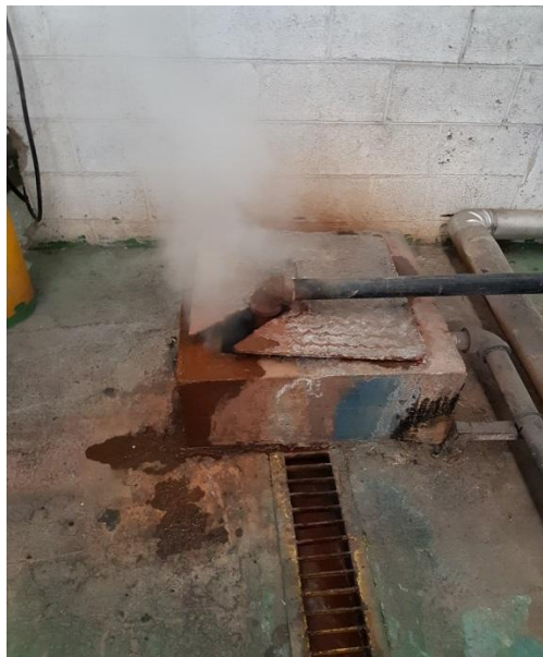
Figura 20. Tanque de recuperación de purga
