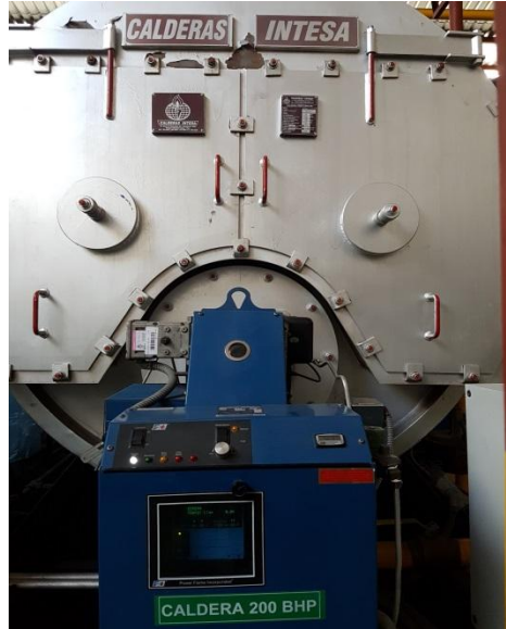
Figura 15. Caldera núm. 4 potencia 200 BHP
