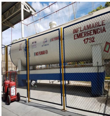
Figura 18. Tanque principal de GLP. Capacidad 11 000 galones
