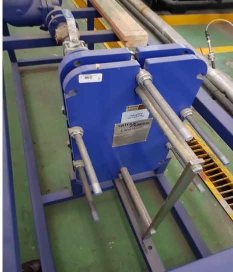
Figura 21. Intercambiador de placas. Capacidad de 7 200 kg/h
