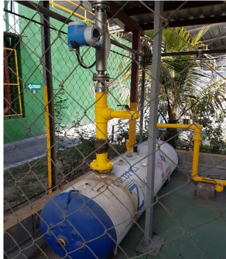
Figura 19. Tanque secundario de GLP. Capacidad 132 galones
