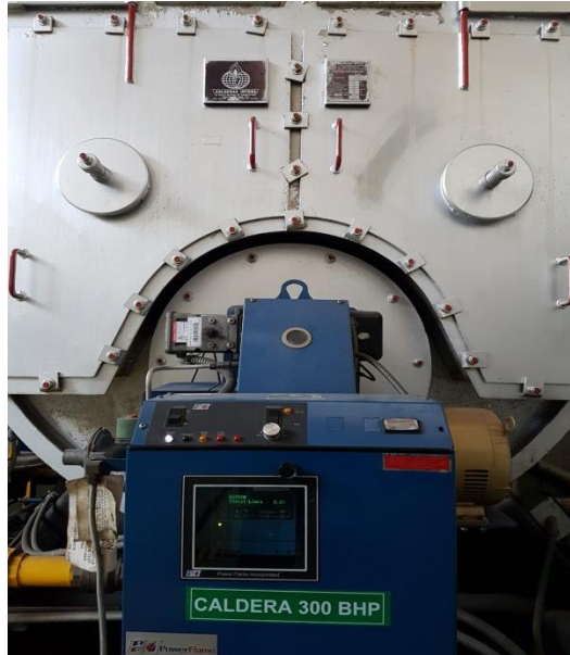
Figura 13. Caldera núm. 3 potencia 300 BHP
