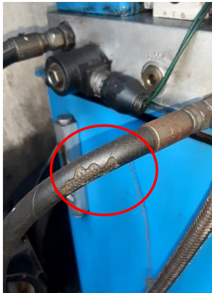
Figura 19. Desgaste en manguera hidráulica
