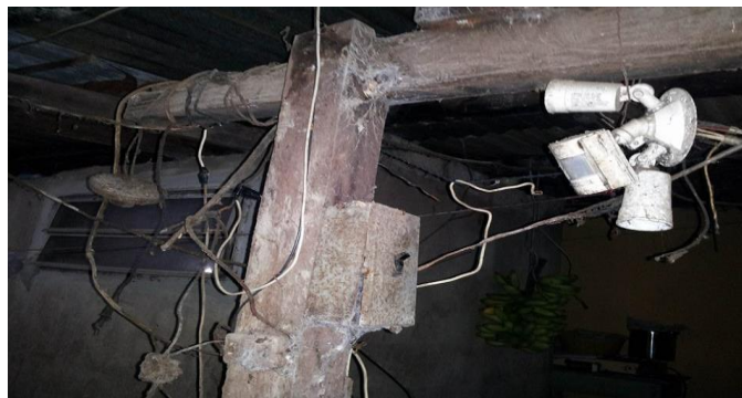
Figura 14. Instalaciones eléctricas en mal estado
