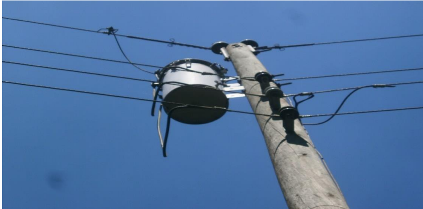
Figura 21. Red de baja tensión abierta
