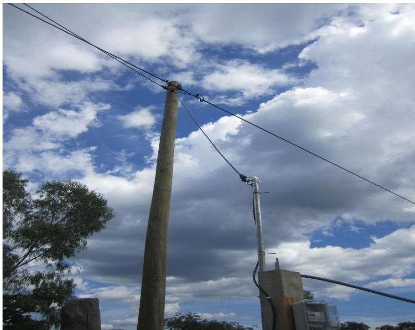
Figura 25. Acometida instalada con cable concéntrico
