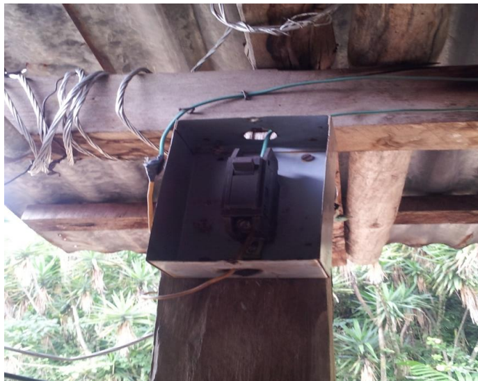
Figura 10. Tablero de protección principal (federal pacific electric)
