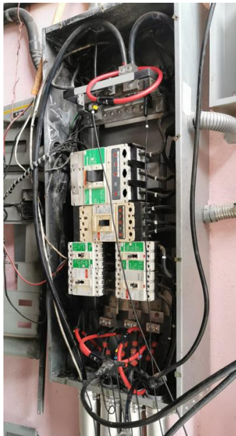
Figura 3. Tablero de distribución principal
