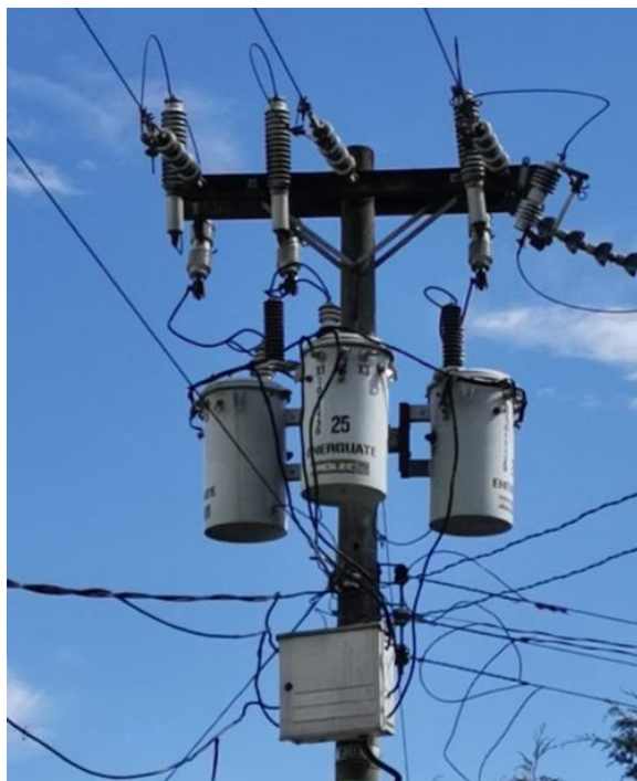
Figura 2. Banco de transformación en poste
