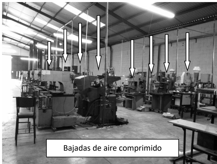
Figura 44. Instalación de aire comprimido en el área de decorado, tubería instalada desde la parte de arriba
