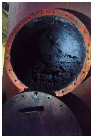
Figura 62. Apertura compuerta recuperador de ceniza saturado
