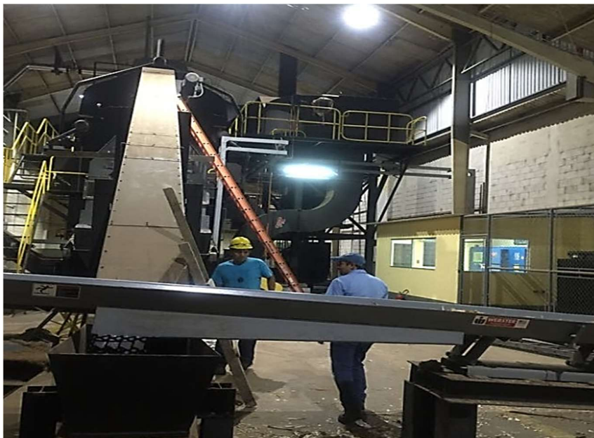
Figura 1. Montaje de la caldera acua piro tubular
