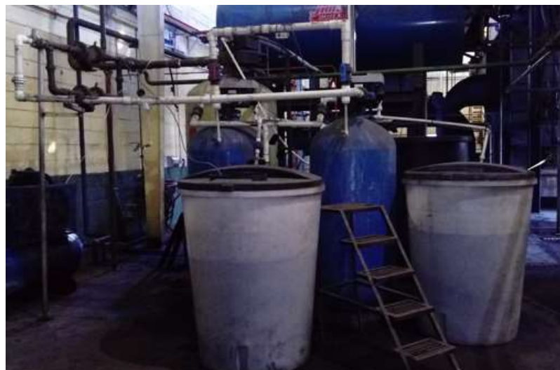
Figura 76. Suavizadores y tanques de salmuera
