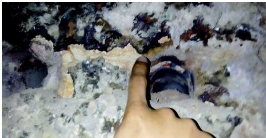
Figura 52. Fisura en cemento refractario I
