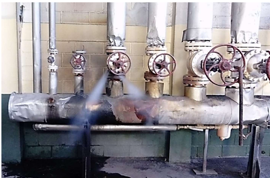
Figura 11. Múltiple de distribución con fuga de vapor
