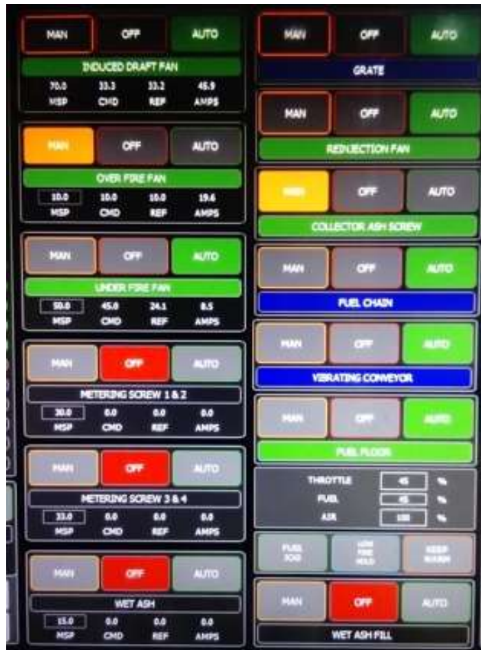
Figura 88. Tablero de operación
