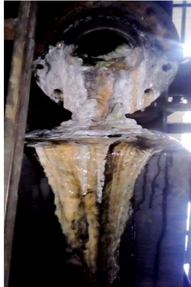
Figura 38. Evacuación de lodos por retiro de brida ciega
