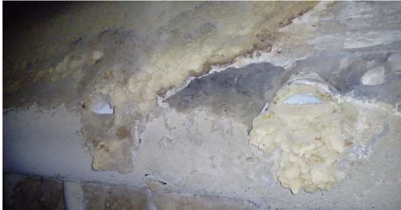
Figura 50. Tubos intermedios de humos obstruidos
