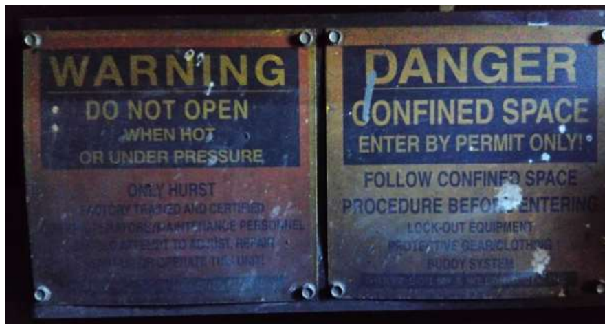
Figura 46. Placa de peligro y advertencia
