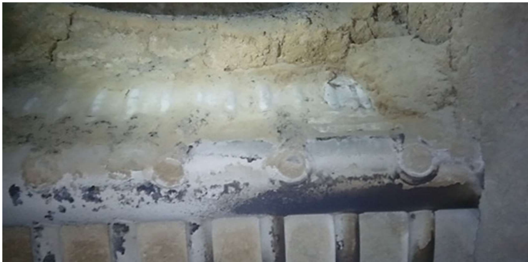
Figura 85. Obstrucciones en tubos y techo intermedio
