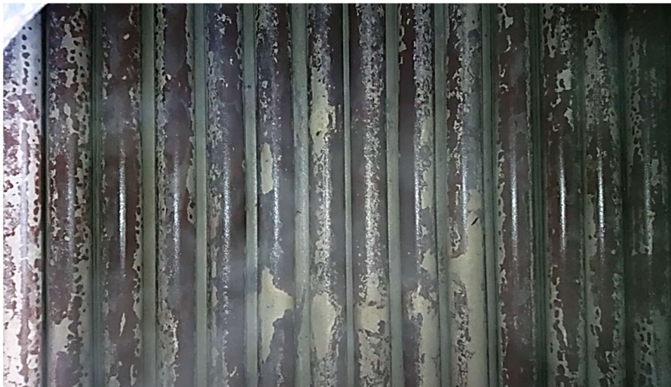
Figura 34. Estado de tubos finalizado ataque químico
