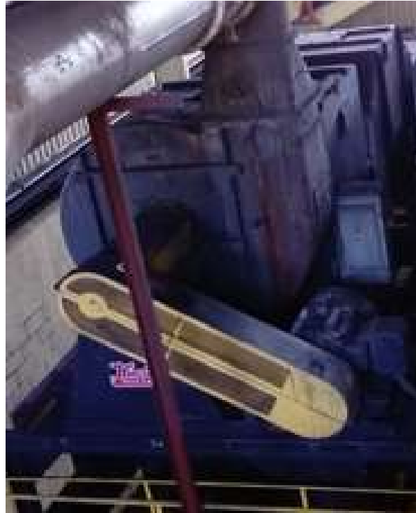
Figura 73. Extractor de humos
