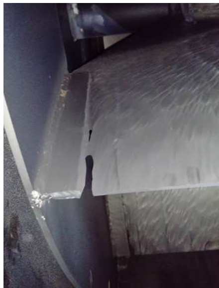
Figura 83. Desgaste ventilador del aire inducido
