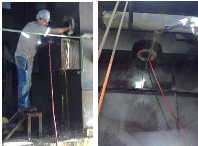
Figura 42. Limpieza de incrustación brida lateral
