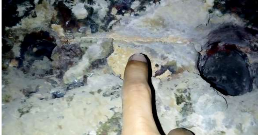
Figura 53. Fisura en cemento refractario II
