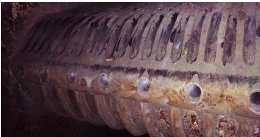
Figura 87. Tubos intermedios de humos liberados
