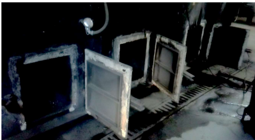
Figura 47. Compuertas parte inferior piso caminante
