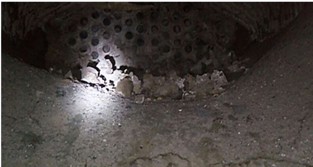
Figura 84. Obstrucciones en tubos pirotubulares
