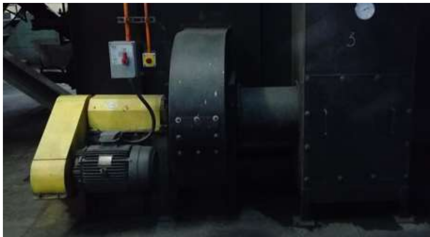
Figura 72. Inyección de aire fuego bajo
