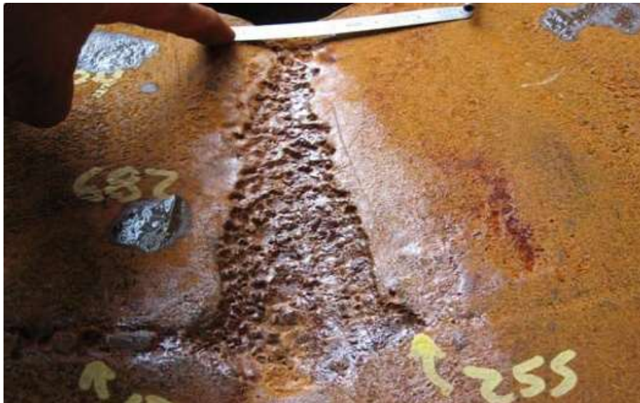
Figura 3. Canal de corrosión en el hogar de agua
