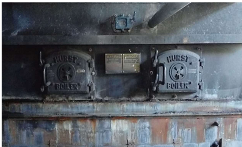
Figura 48. Compuertas frontales acceso y mirilla hogar de fuego
