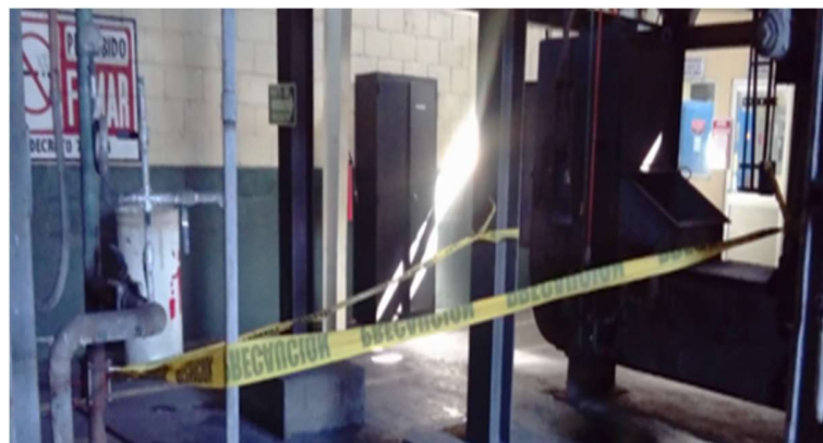
Figura 28. Acordonamiento de área de peligro en el trabajo
