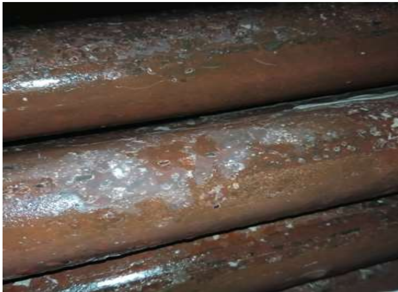
Figura 37. Estado de tubos después del enjuague
