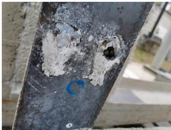
Figura 34. Superficie de falla donde los pernos se desprendieron del patín de la viga
