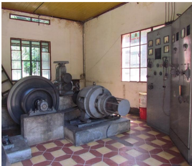
Figura 45. Interior de la casa de máquinas
