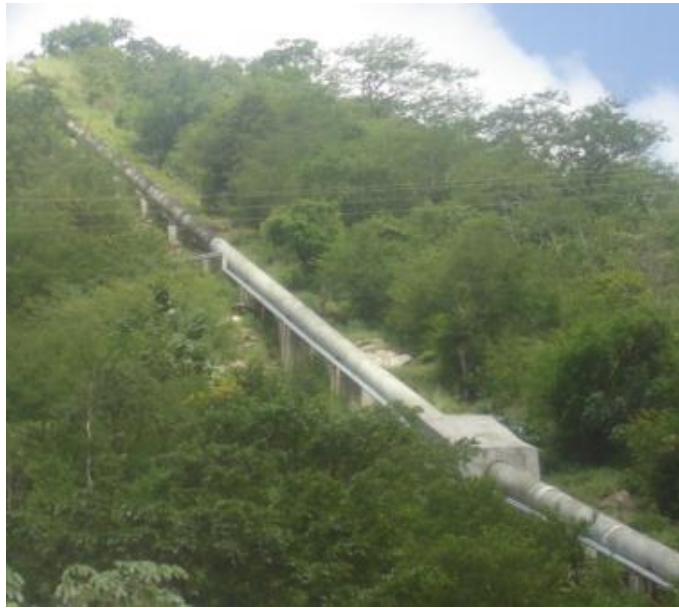
Figura 4. Tubería de presión hidroeléctrica Pasabien
