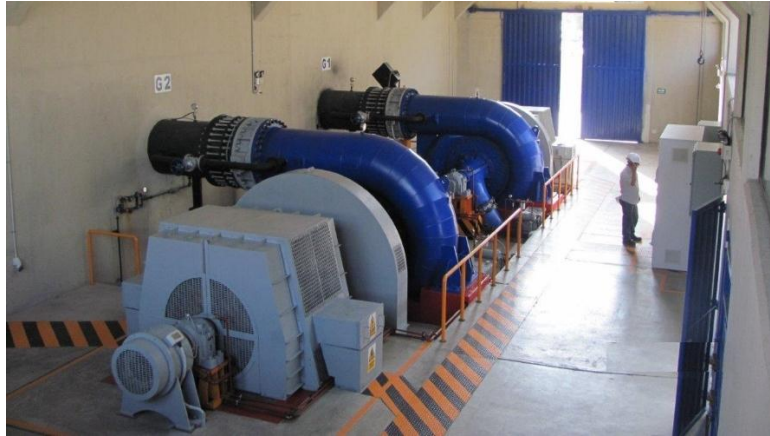
Figura 5. Casa de máquinas
