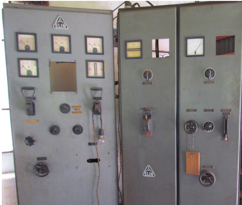
Figura 47. Tableros de medición y control
