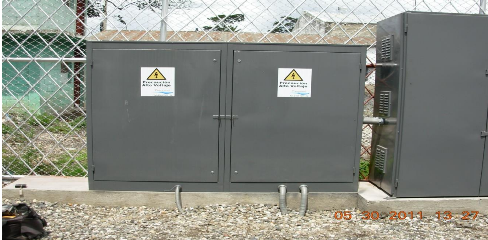
Figura 19. Gabinete contenedor de baterías
