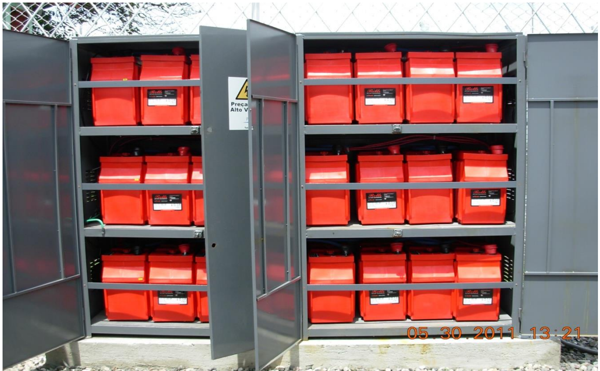
Figura 18. Banco de 24 baterías del sistema DOD
