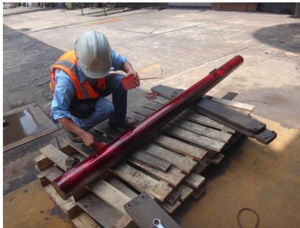
Figura 38. Ensayo de líquidos penetrantes
