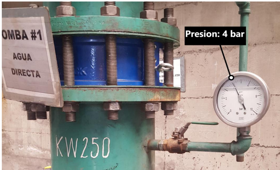
Figura 32. Presión de bomba, cuarto de bombas
