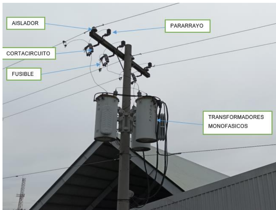
Figura 3. Banco de transformadores de distribución
