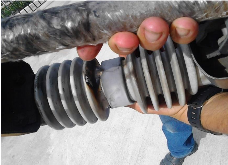
Figura 5. Falla ocasionada por cortocircuito
