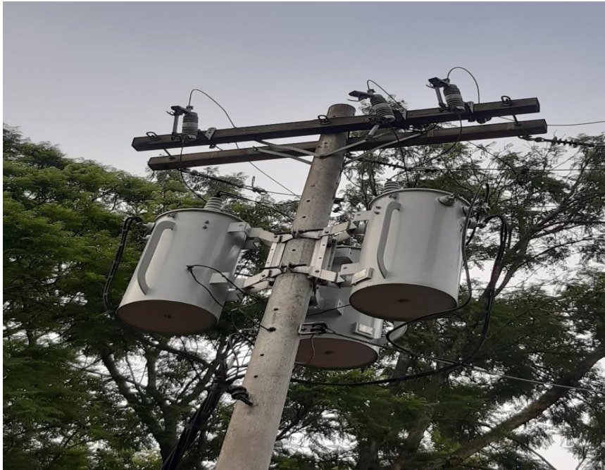
Figura 7. Falla ocasionada por un ave
