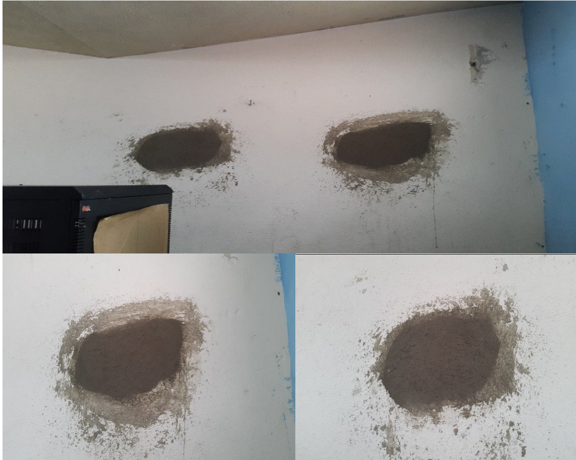
Figura 6. Sellado de agujeros en la pared de la sala de proyección auditorio Francisco Vela
