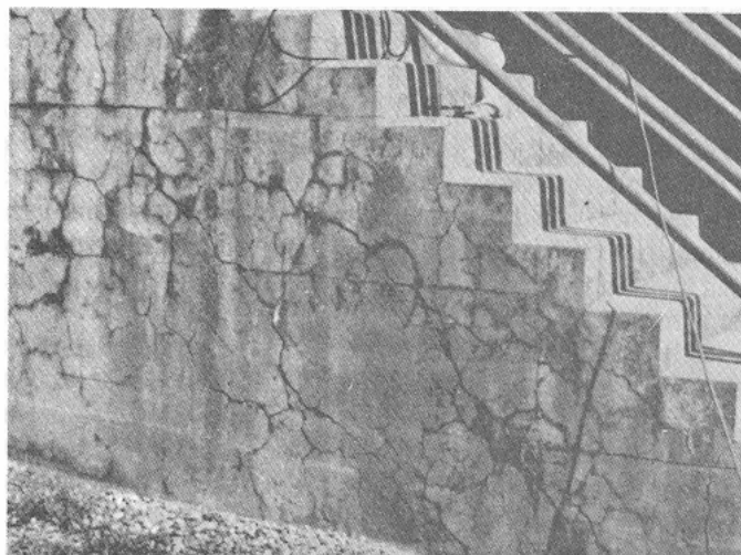
Figura 8. Deterioro del concreto por reactividad álcali-agregado (9-44)
