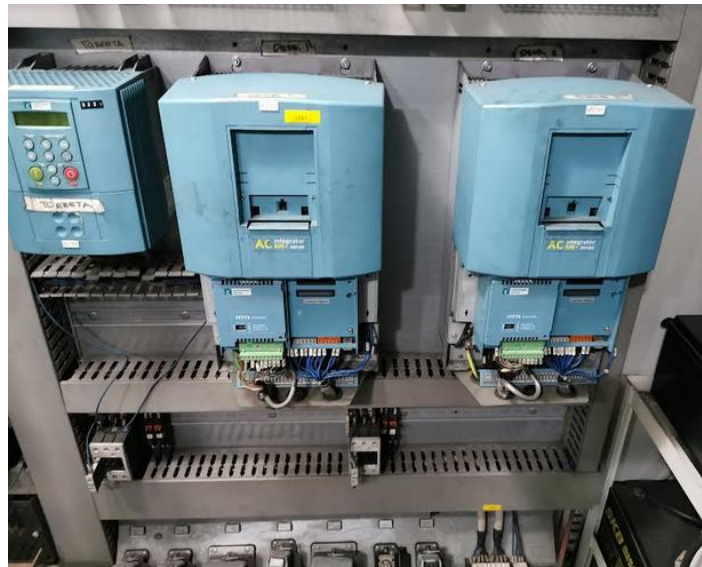
Figura 33. Variadores de frecuencia
