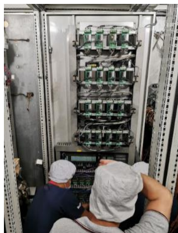
Figura 34. Controladores de Servomotores
