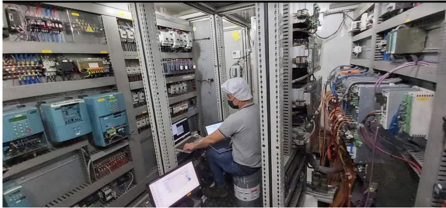
Figura 43. Configuración y parametrización de controladores
