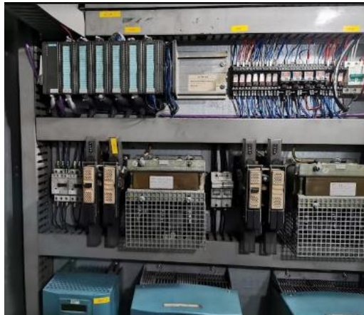
Figura 35. PLC Siemens esclavo
