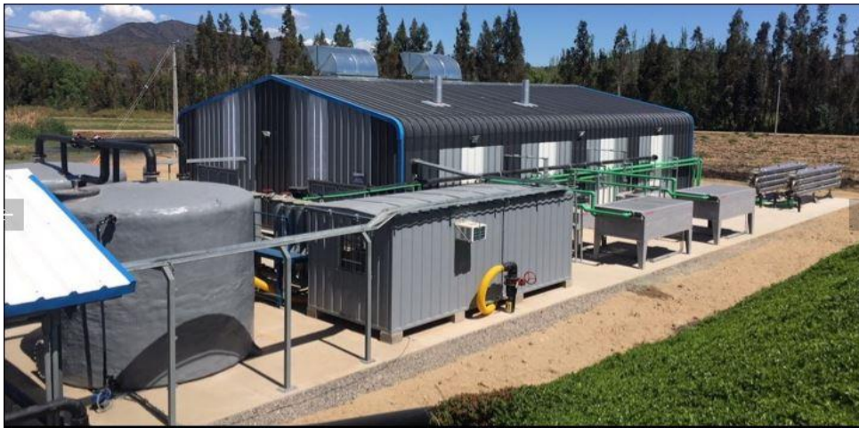
Figura 18. Tren de limpieza de biogás
