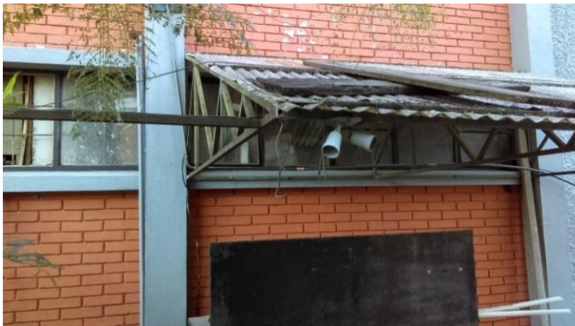
Figura 11. Sistema de iluminación 2/2, condición inicial
