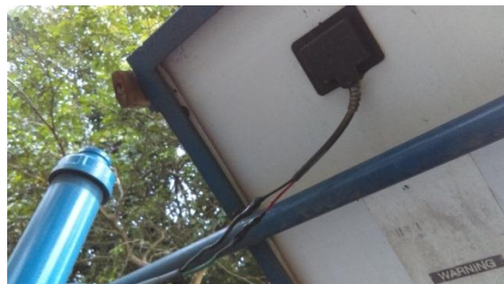
Figura 36. Panel fotovoltaico izquierdo, antes
