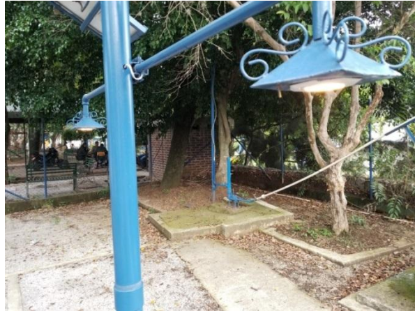
Figura 42. Iluminación con energía solar a 12 VCC
