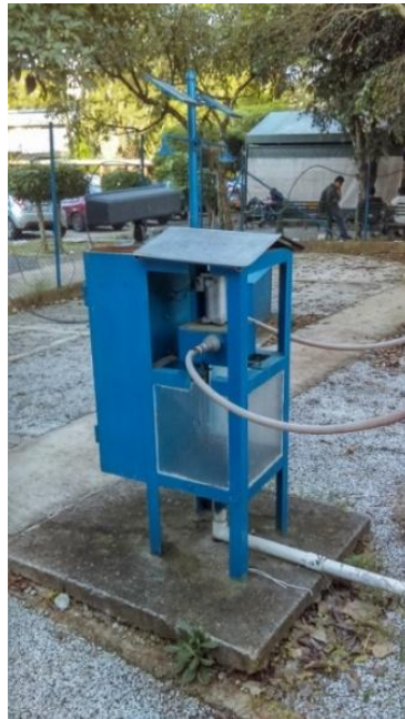
Figura 1. Turbina Pelton, condición inicial
