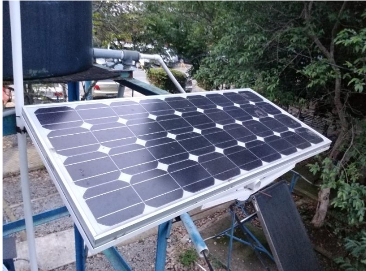
Figura 62. Panel fotovoltaico instalado
