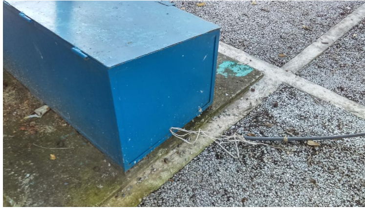
Figura 27. Contenedor de paneles fotovoltaicos
