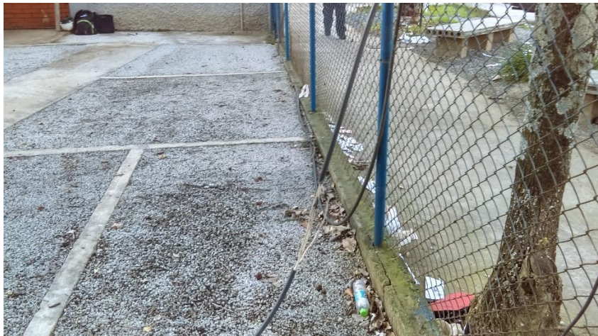
Figura 26. Cableado eléctrico a contenedor de paneles fotovoltaicos
