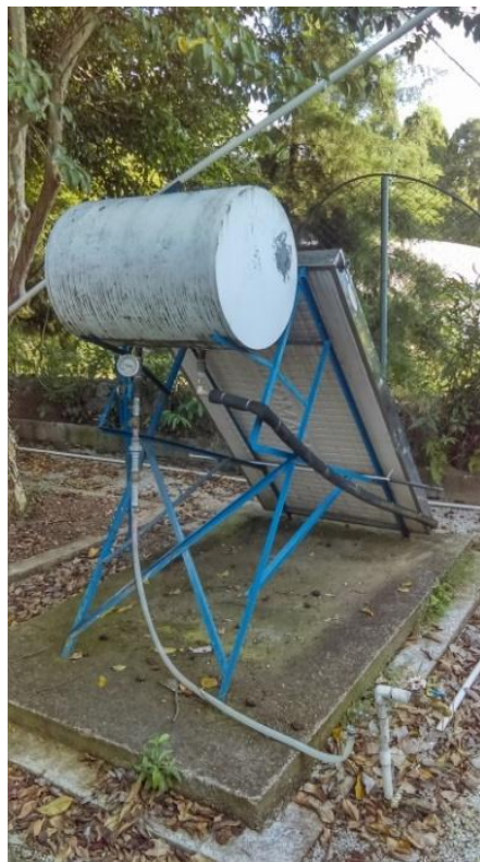
Figura 8. Colector Solar, condición inicial
