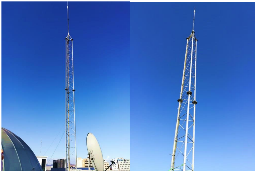
Figura 73. Pararrayos instalado en el edificio 2 del MINEDUC
