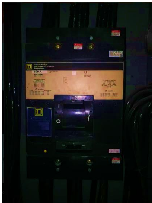
Figura 17. Interruptor principal trifásico termomagnético de 800 A en edificio 2
