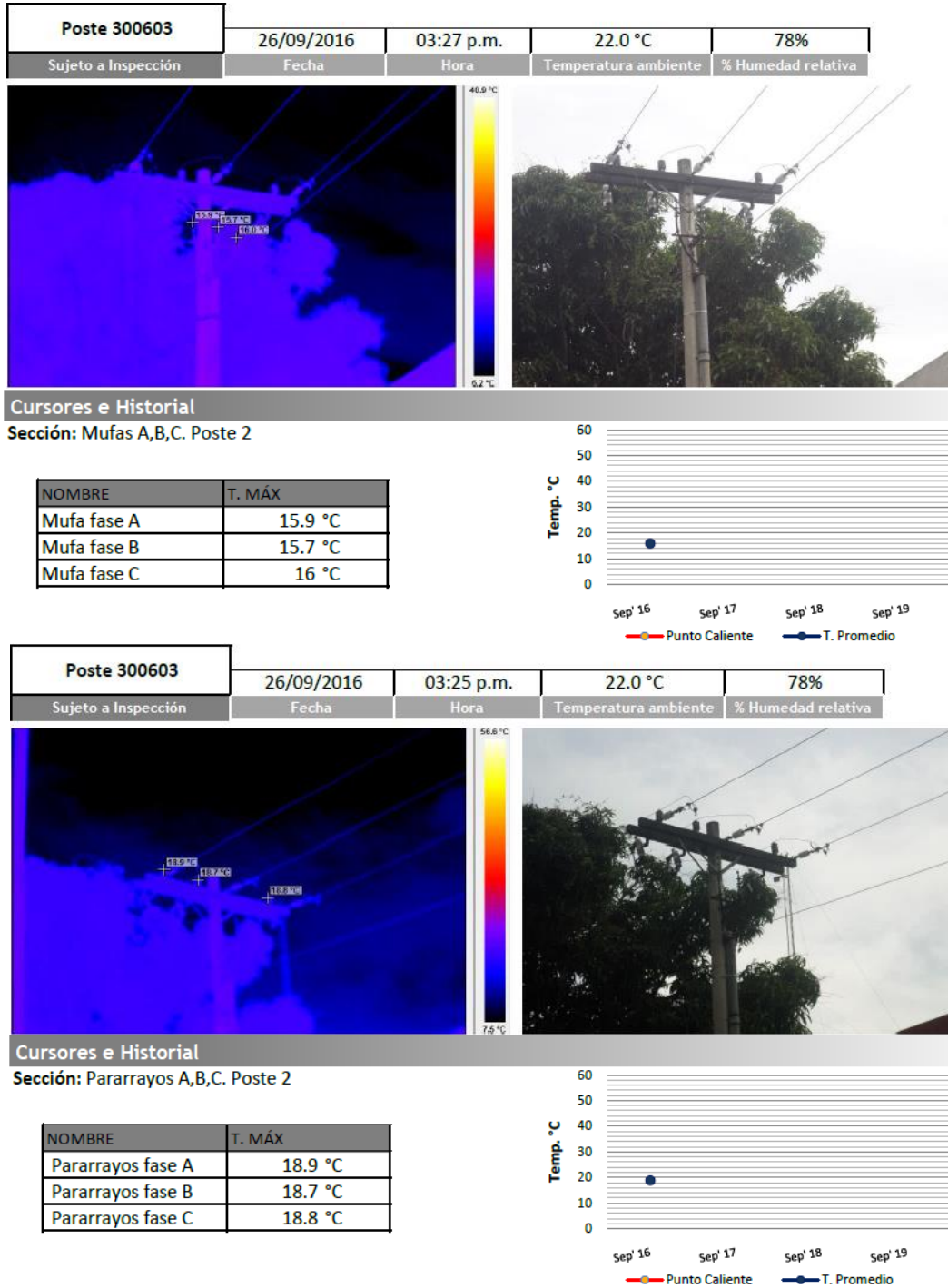
Figura 21. Termografía en mufas y pararrayos
