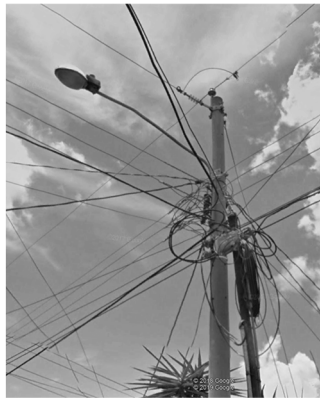
Figura 33. Baja tensión conductor abierto con derivación.
