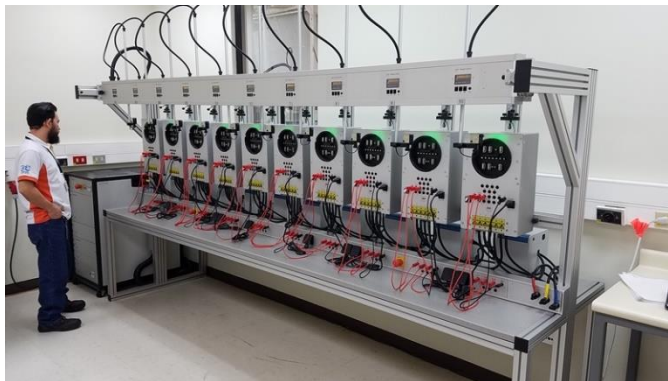
Figura 12. Mesa de calibración de medidores de energía de múltiples posiciones
