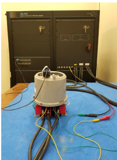
Figura 53. Medidor de energía conectado al equipo patrón
