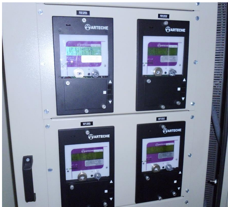
Figura 17. Medidores electrónicos principales y de respaldo de una subestación de maniobra
