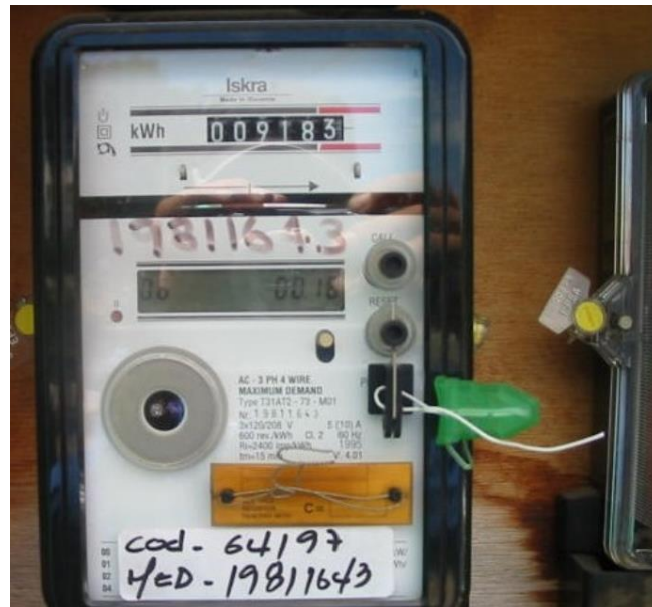
Figura 19. Medidor de energía híbrido
