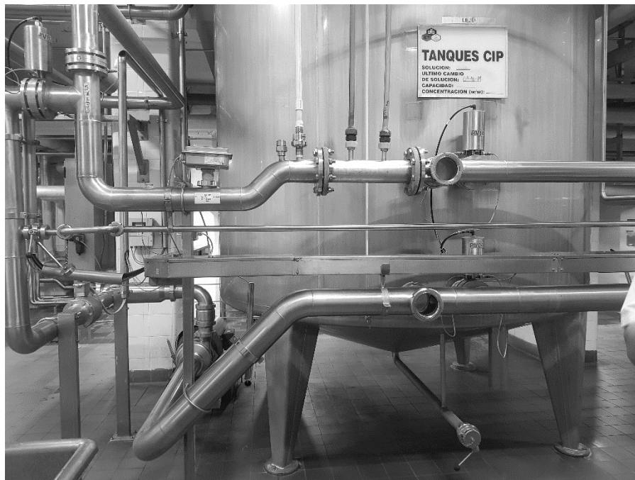
Figura 13. Sistema de recirculación del tanque de ácido-desinfectante
