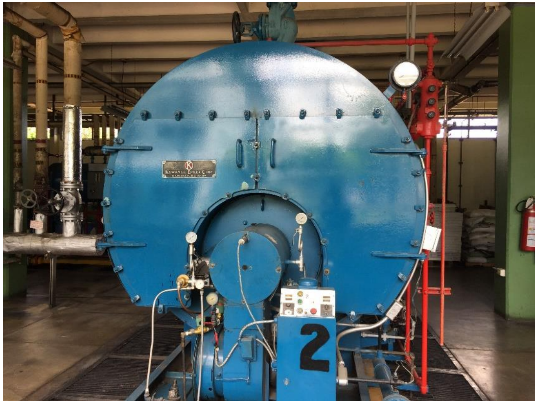
Figura 7. Caldera núm. 2 pirotubular
