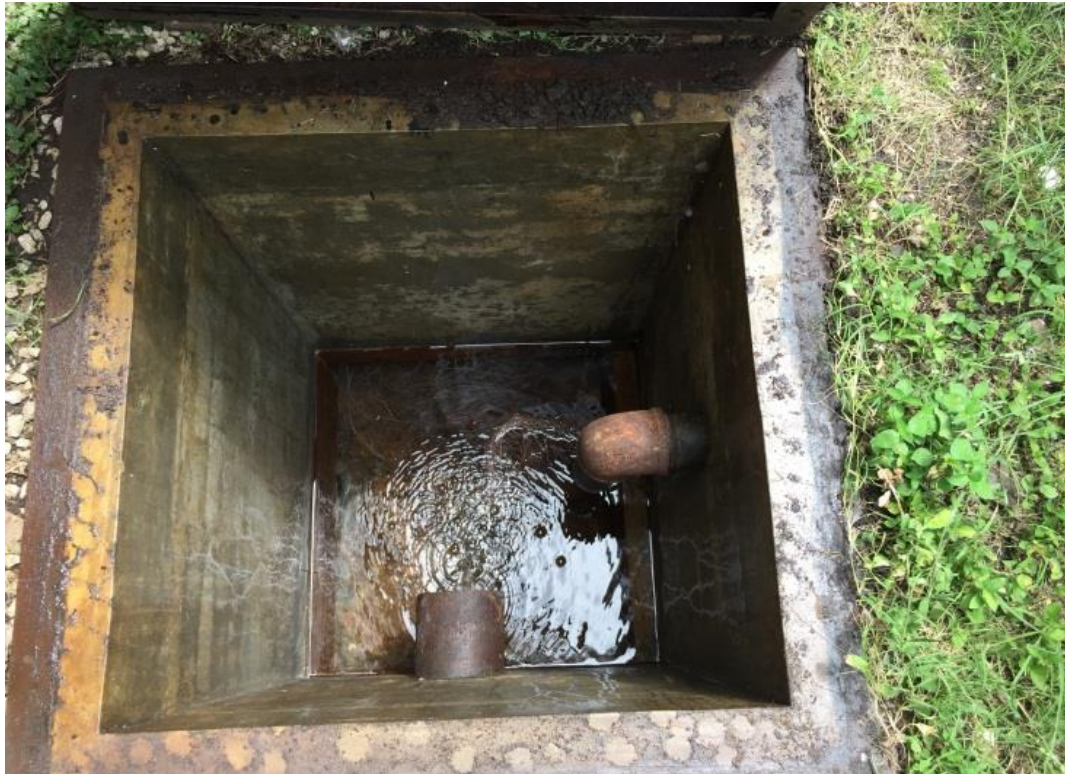
Figura 12. Fuga en la tubería de purga
