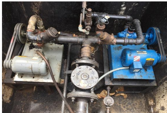
Figura 23. Sistema de bombeo de combustible búnker del tanque hacía el tanque diario para búnker
