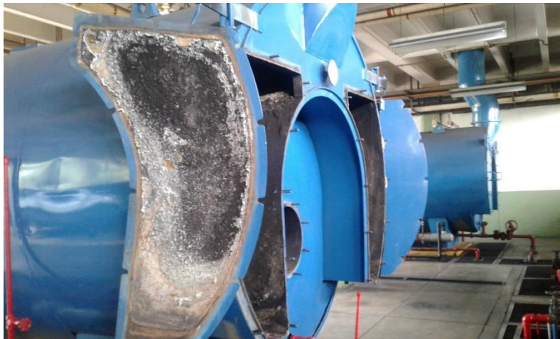
Figura 32. Parte trasera de la caldera en el proceso de mantenimiento preventivo
