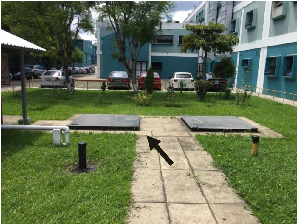
Figura 20. Tanque para combustible búnker
