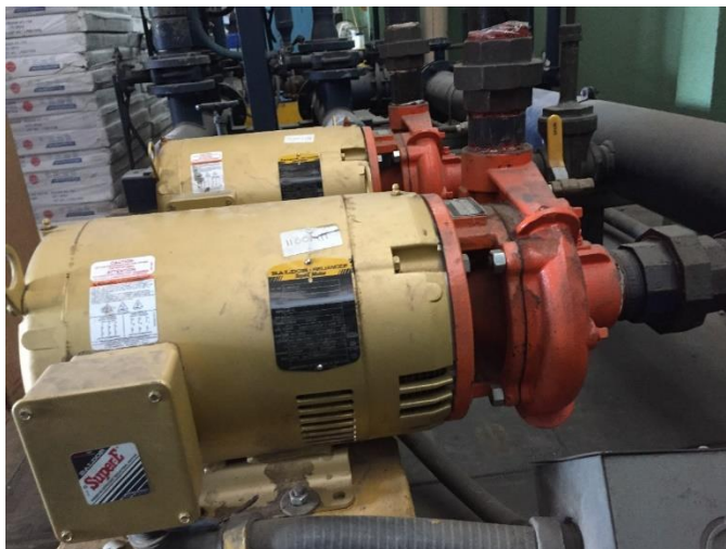
Figura 27. Bomba centrífuga para la distribución de agua a todo el hospital
