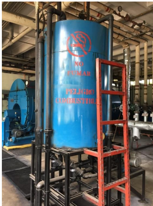
Figura 21. Tanque diario para combustible búnker
