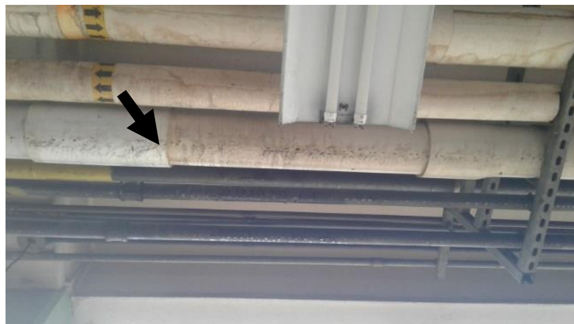
Figura 11. Fuga en la tubería
