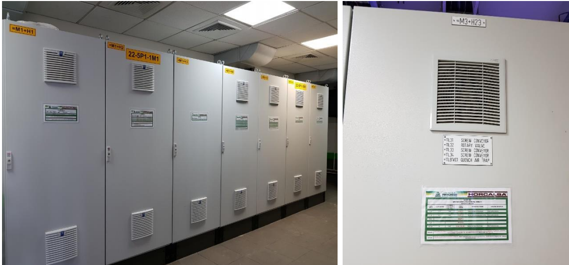
Figura 79. Paneles eléctricos en planta de cal
