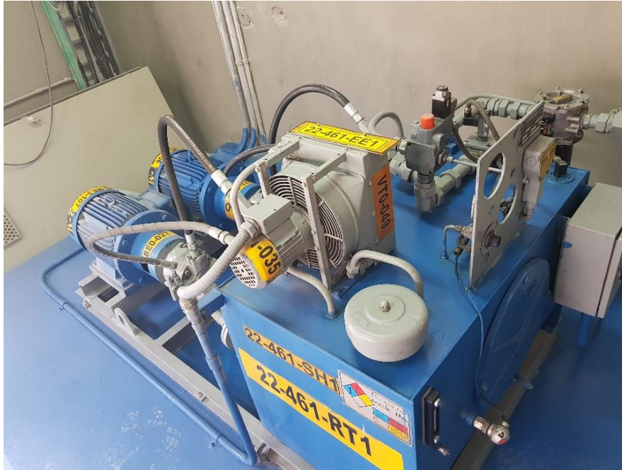
Figura 64. Identificación de equipos
