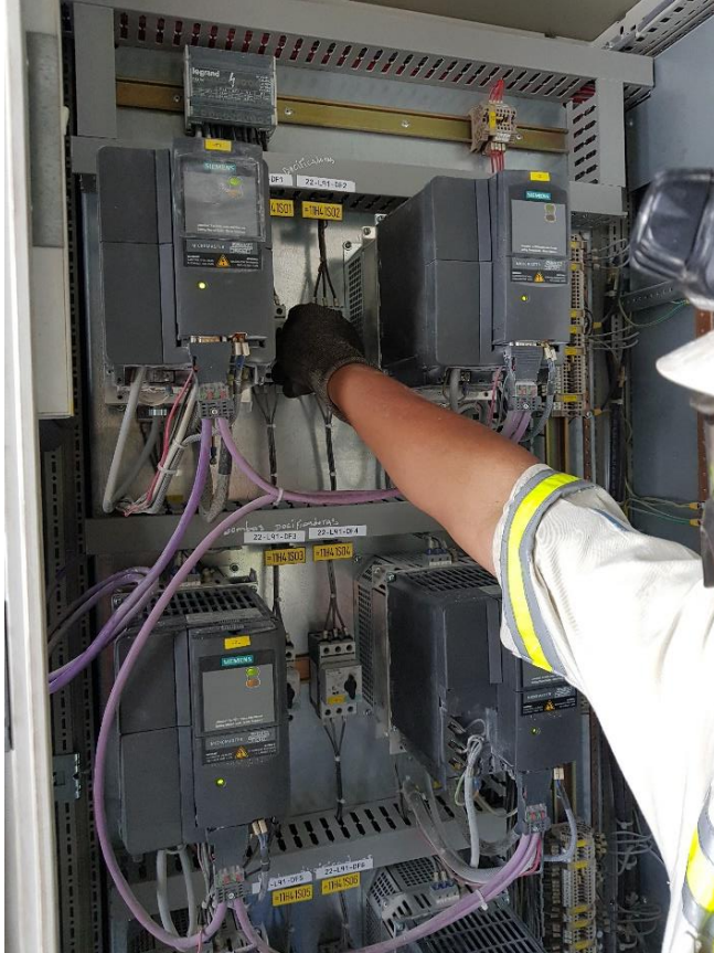
Figura 75. Pruebas de bloqueo en paneles eléctricos
