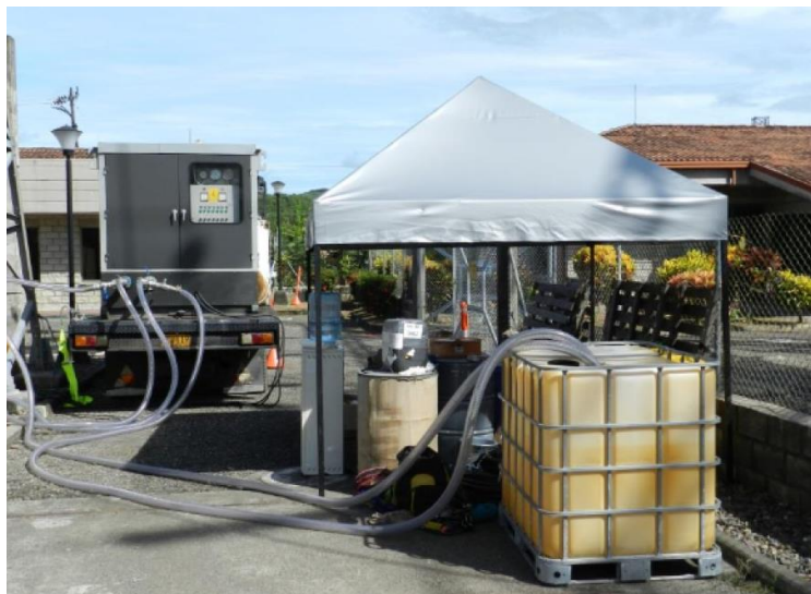
Figura 39. Planta de tratamiento
