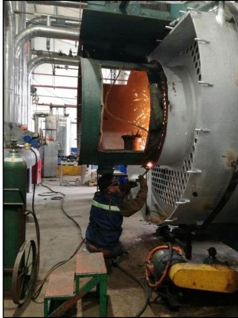
Figura 31. Corte de antiguo soporte de quemador
