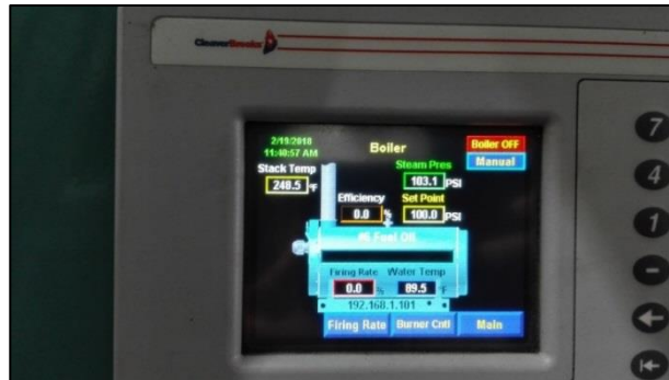
Figura 73. Condiciones de prueba de alarma y apagado automático de caldera por incremento de presión
