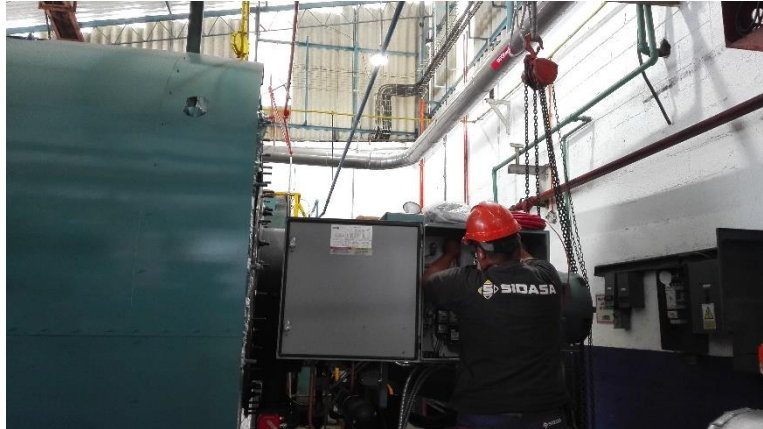
Figura 57. Conexión de componentes en panel de control
