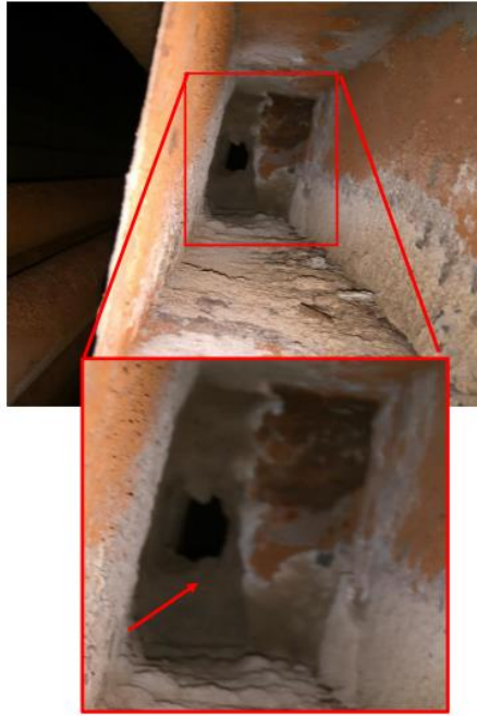
Figura 88. Incrustación en difusor de entrada de agua a caldera
