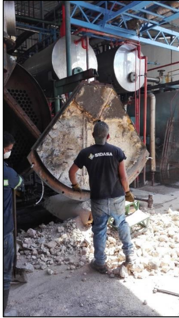
Figura 18. Rompimiento de refractario en puerta trasera
