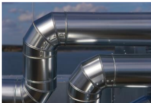
Figura 21. Tubería con aislante térmico
