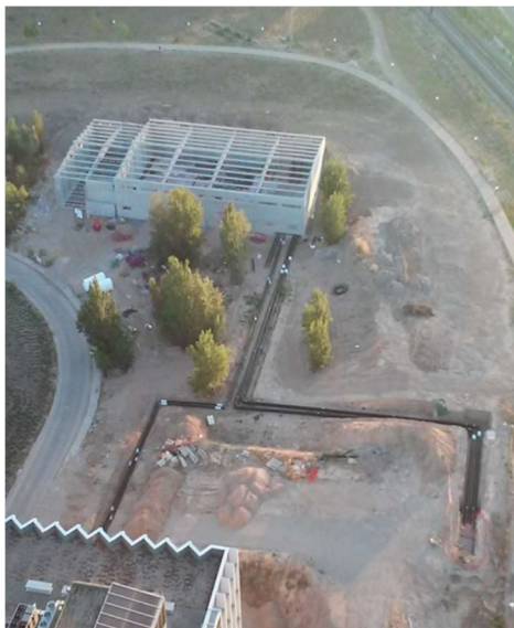
Figura 3. Vista aérea de central térmica
