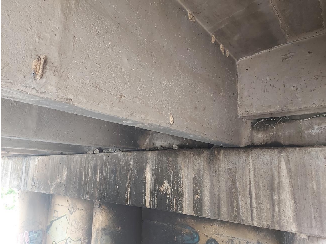
Figura 25. Puente RD-GUA-47 kilómetro 0+600, tope sísmico continuo
