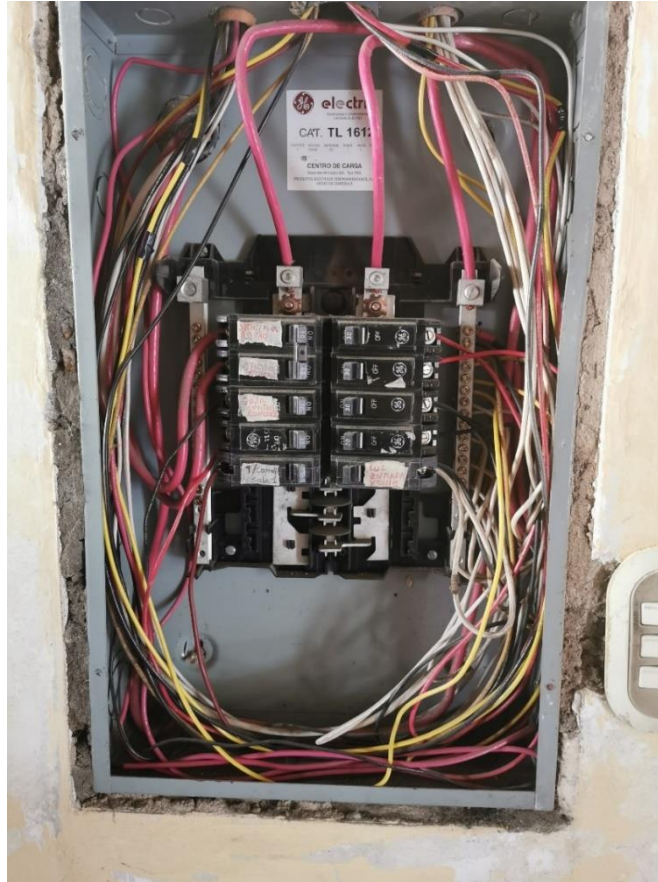
Figura 22. Tablero principal de distribución Museo del Libro Antiguo
