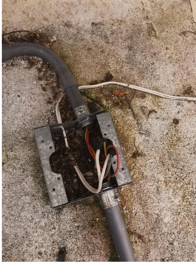
Figura 25. Caja de registro con instalación defectuosa
