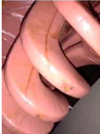
Figura 54. Estado de cabezas de bobina previo a dar mantenimiento
