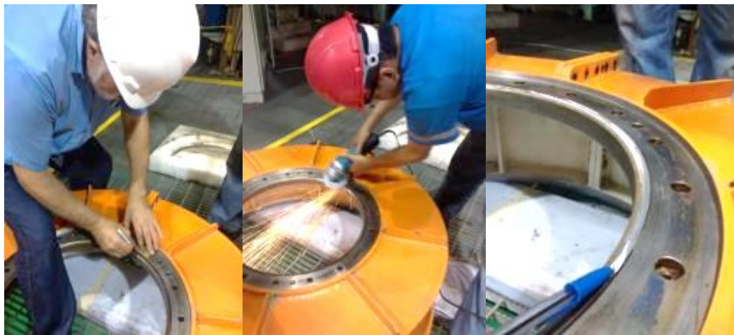
Figura 90. Ampliación del radio en tapa de cojinete guía de turbina, para la disminución de fugas de aceite
