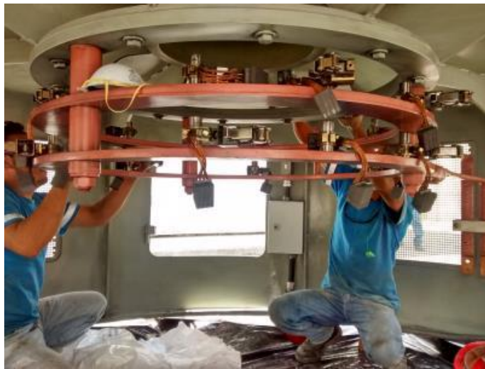
Figura 15. Desmontaje de anillos colectores y limpieza de ventanas visores del sistema colector
