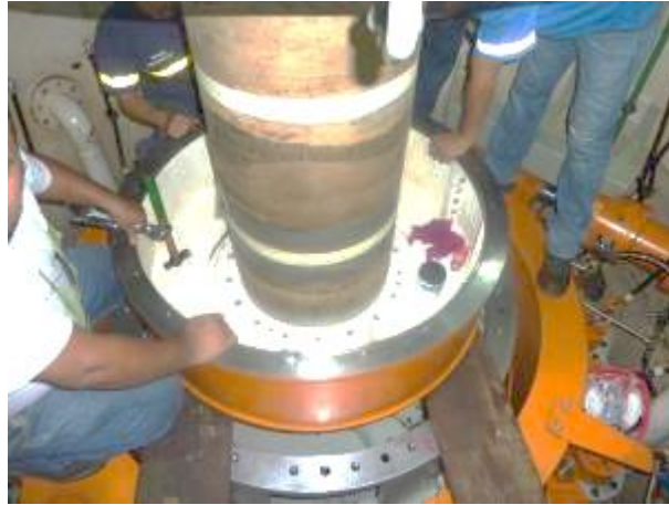
Figura 91. Montaje de tapa de cojinete guía de turbina, después de limpiezas y ampliación de radio
