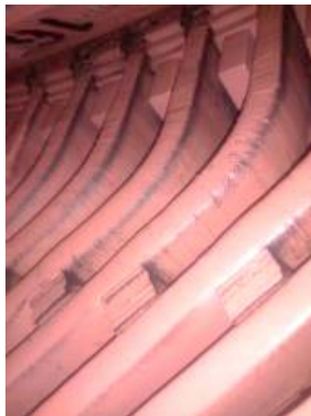
Figura 55. Cabezas de bobina con presencia de suciedad
