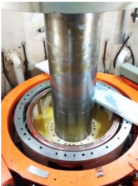
Figura 79. Apertura de cuba y vaciado de aceite en cojinete guía de turbina
