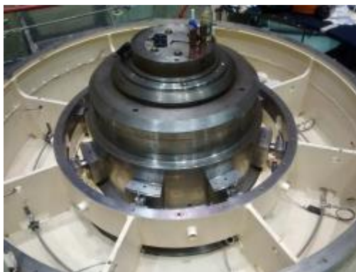
Figura 32. Instalación de instrumentación en cuba de cojinete combinado, instalación tubería de alta presión
