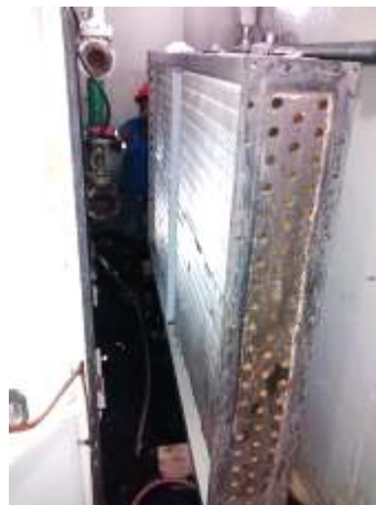
Figura 57. Radiador del sistema de enfriamiento antes de mantenimiento
