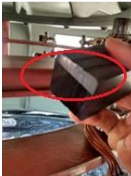
Figura 18. Escobilla dañada por desgaste
