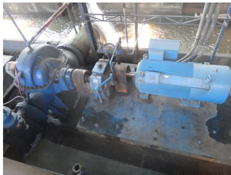
Figura 5. Equipo de bombeo de agua hacia condensadores
