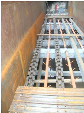
Figura 26. Cadena 960 para montaje de tablillas y flautas de vapor para limpieza de conductor
