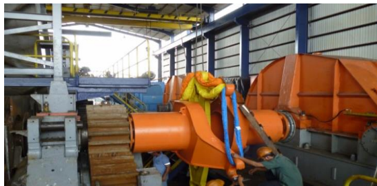
Figura 72. Montaje de eslingas de retorno en enganches de elementos de sistema de acople flexible
