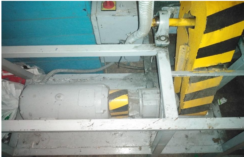
Figura 26. Falta de limpieza periódica
