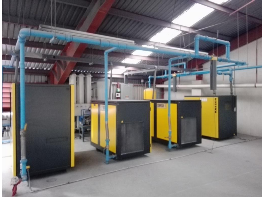
Figura 6. Cuarto de compresores
