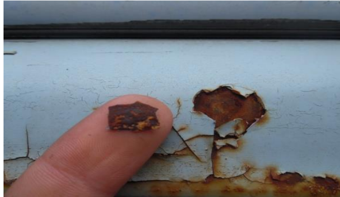
Figura 2. Corrosión, desprendimiento significativo de metal
