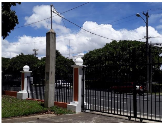
Figura 37. Acometida eléctrica MUNAE
