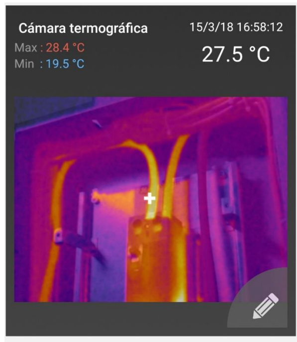
Figura 45. Termografía breaker tablero principal MUANE
