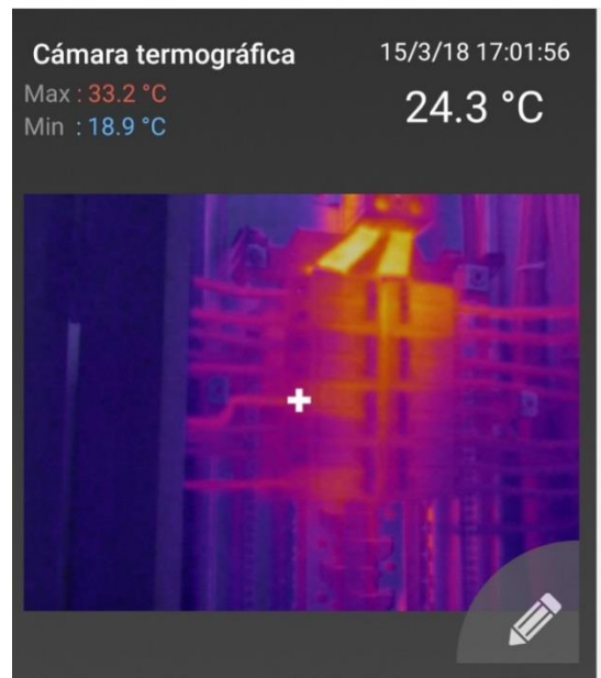
Figura 46. Termografía tablero principal de distribución MUNAE
