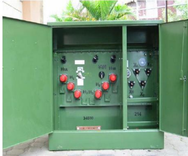
Figura 3. Transformador tipo pedestal
